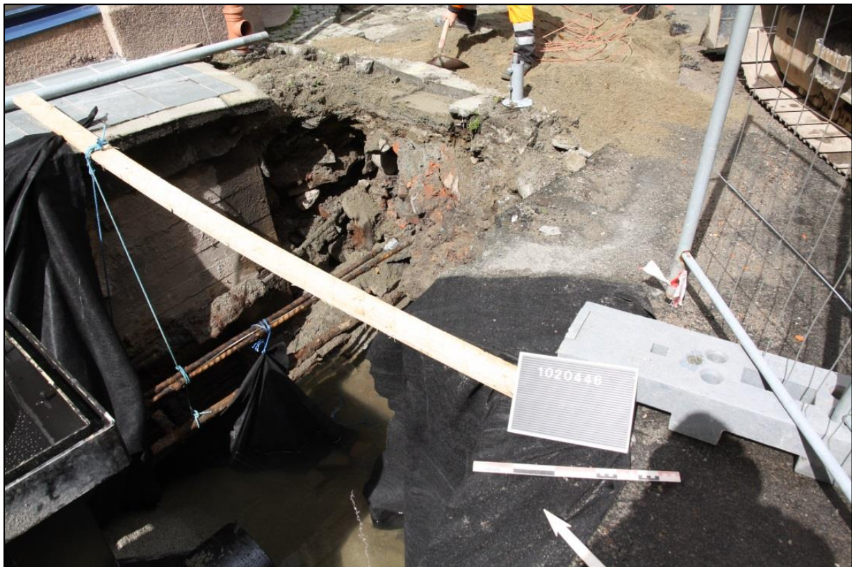
Figur 2. Grøften i Altonagaten ferdig gravd. Eldre infrastruktur og forskaling inn mot C. Sundts gate 22 er synlig. Niku_ark_335498.
