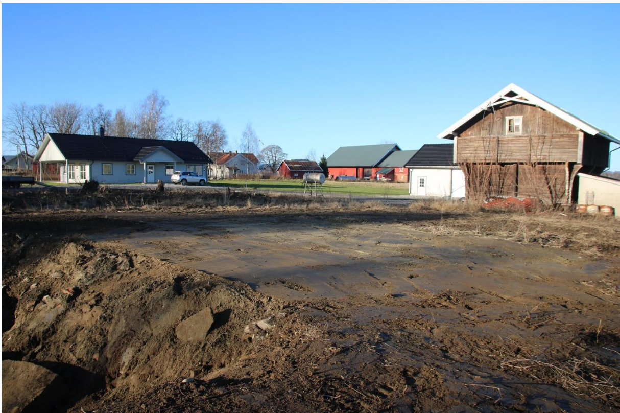
Figur 5: Flaten nord for kjellergropen etter fjerning av brann- og rivningsmasser. Sett mot nordvest. Foto: Cf54078_NIKU_30.
