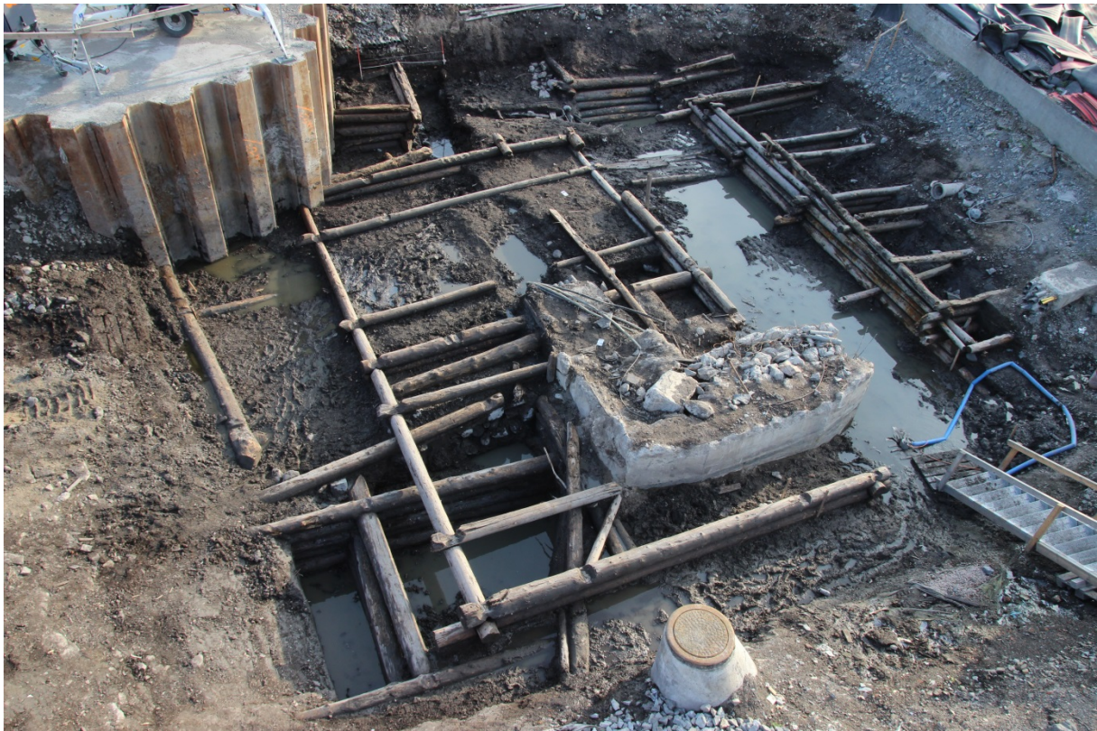
Figur 41: niku_ark_333639 Laftekasse K209 sentralt i bildet. Legg merke til betonginstallasjonen (K19) i konstruksjonens nordvestre del. Foto mot sør.
