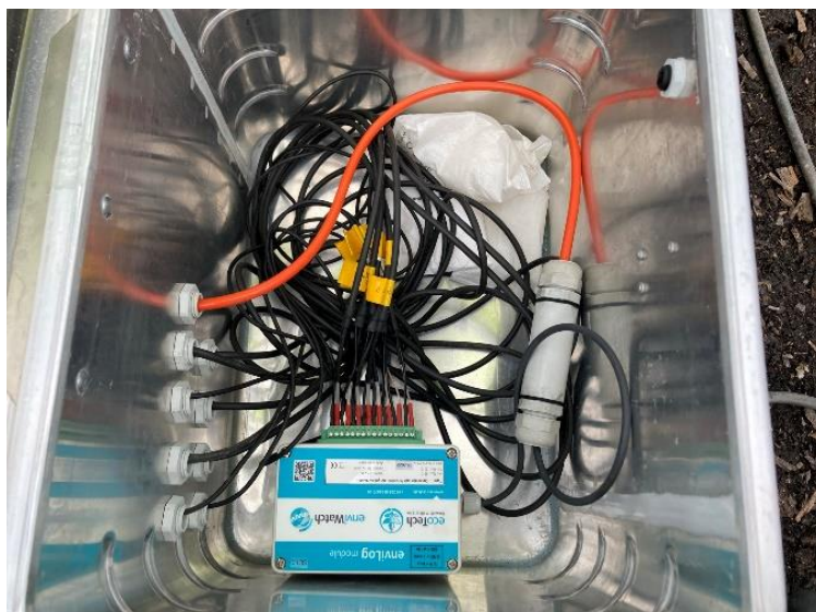
Figur 20: Koblingsboks for profil. Foto: Cautus Geo AS.
