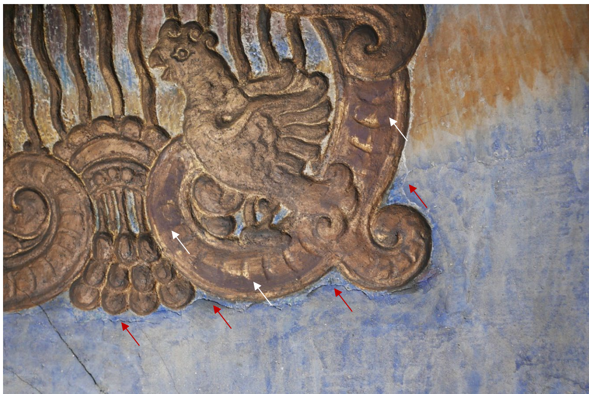
Figur 7 Detaljbilde fra rankedekor og hvelvmaleri i kolumbariet. Malingen mellom stukkatur-elementene skiller seg fra teknikken generelt. På elementet under fuglen sees en mørk patinering over bronseringen, (indikert med hvite piler). Dette er en tidligere reparasjon. Grovere puss er lagt på etter og rundt stukkaturen, som overlapper underlaget stukkaturen er utført på, som antyder at stukkaturen ble utført først (kant er indikert med røde piler).
