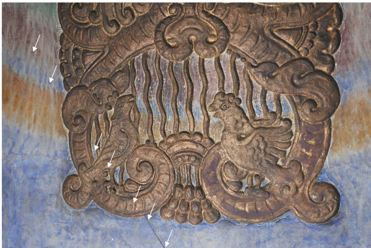
Figur 23 Detaljbilde av sprekk i pussen og stukkturkorset i østre kolumbarium (indikert med piler). Sprekkene er stabile.
