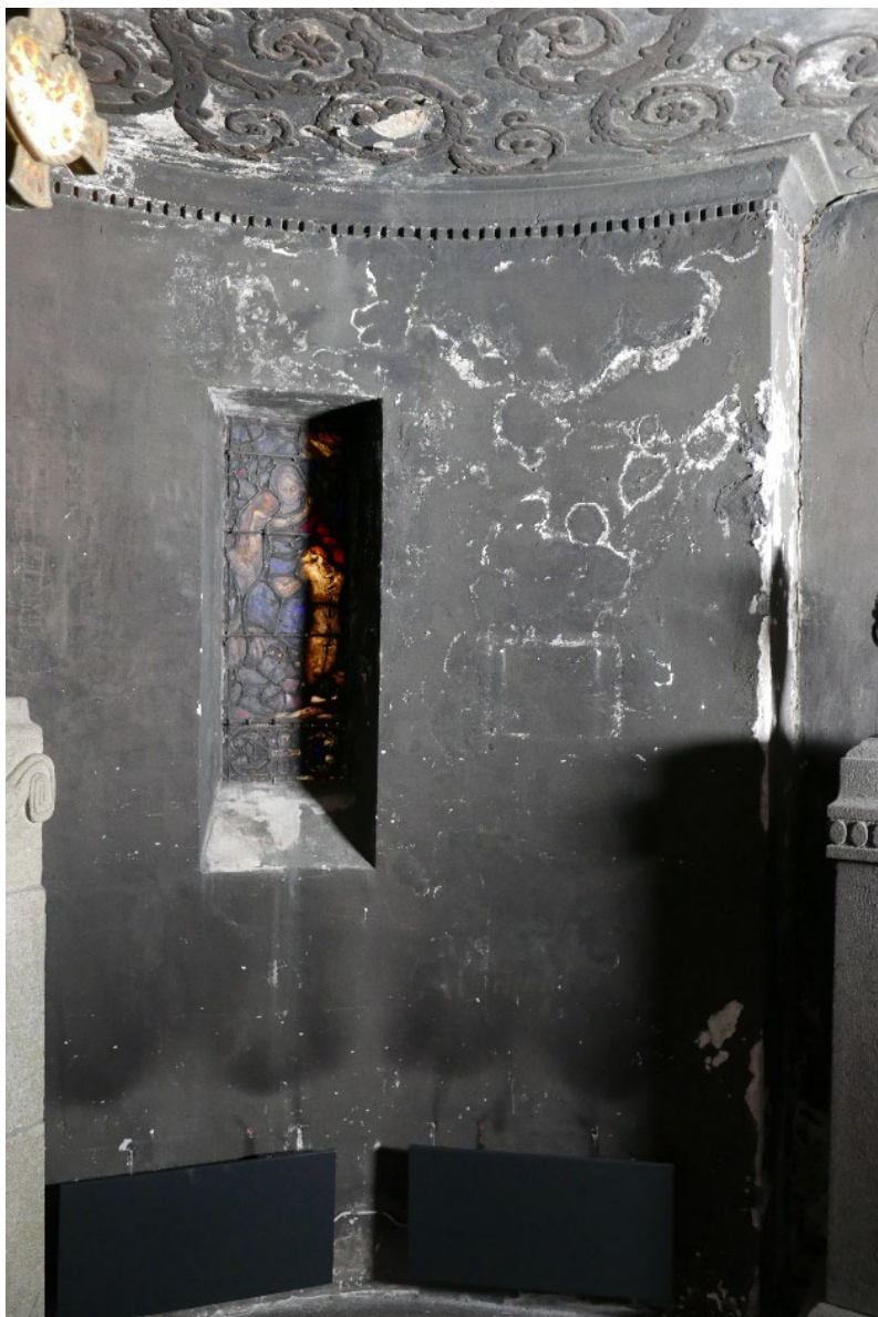
Figur 28 Skade på vegg grunnet fukt i østre kolumbarium. Muren er nå tørr. I bildet kan man også se glassmaleri, som bør tilstandsvurderes og renses.
