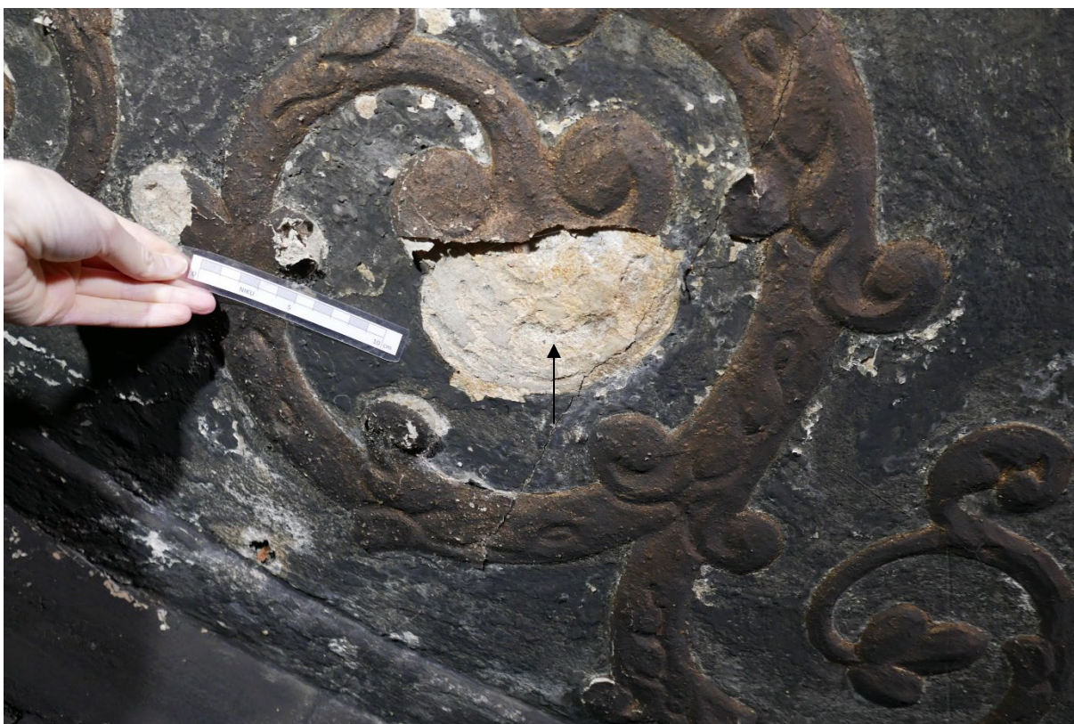
Figur 12 Stukkaturpussen i det flate taket i kolumbariet er mer kompakt og virker mindre kornete, til sammenligning med pussen i katafalken, som vist i figur 11. Pussoverflaten under stukkaturen er skrappt opp, antakelig for å gi bedre vedheft for stukkaturen (indikert med pil).
