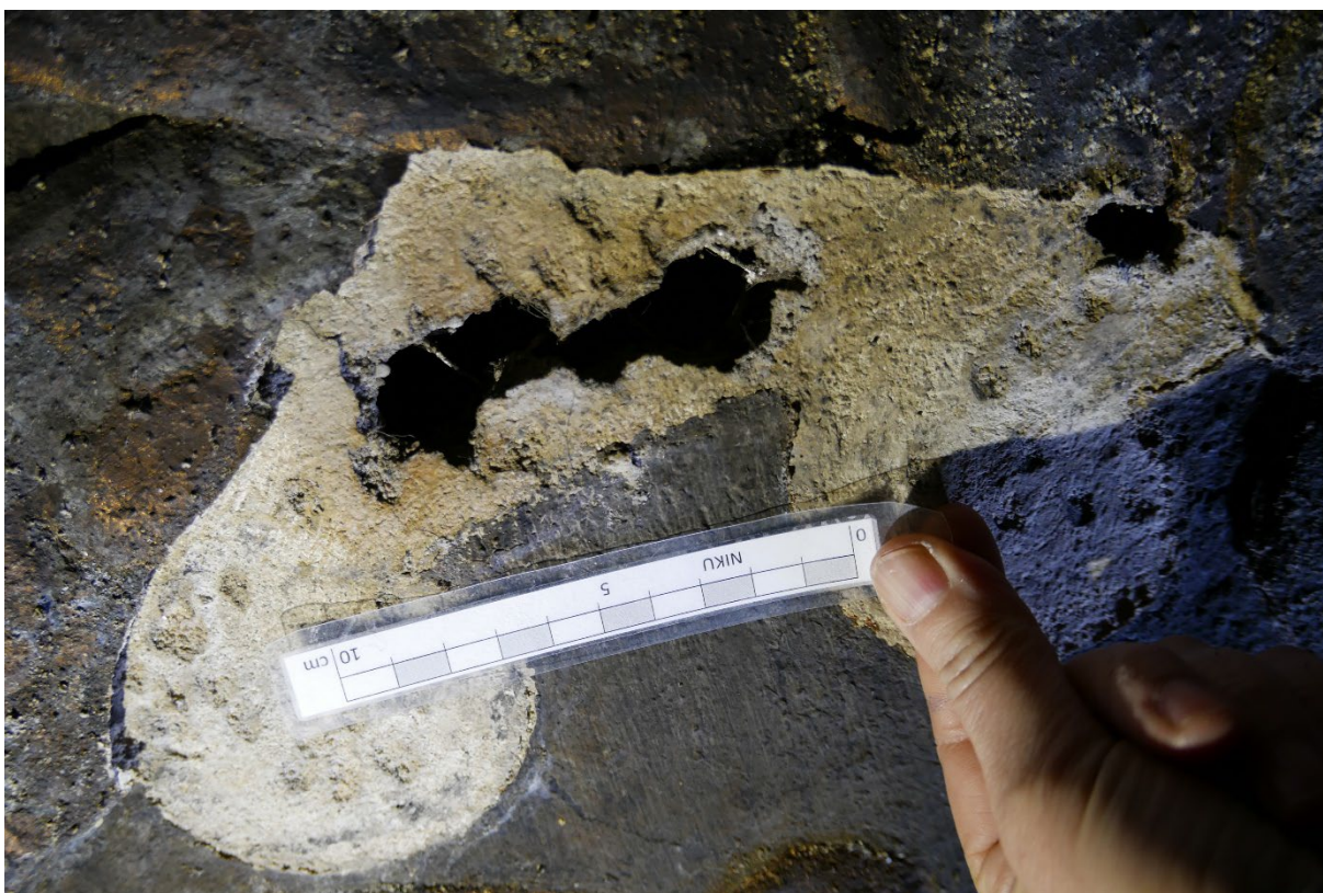
Figur 26 Et hull gjennom hele pussen i kolumbariet i et område med tapt stukkatur. Stukkaturelementet har falt av i et helt stykke og hakk/skraper vises på pussoverflaten (for å bedre vedheft). Gjennom hullet kunne litt av strukturen under pussen observeres.
