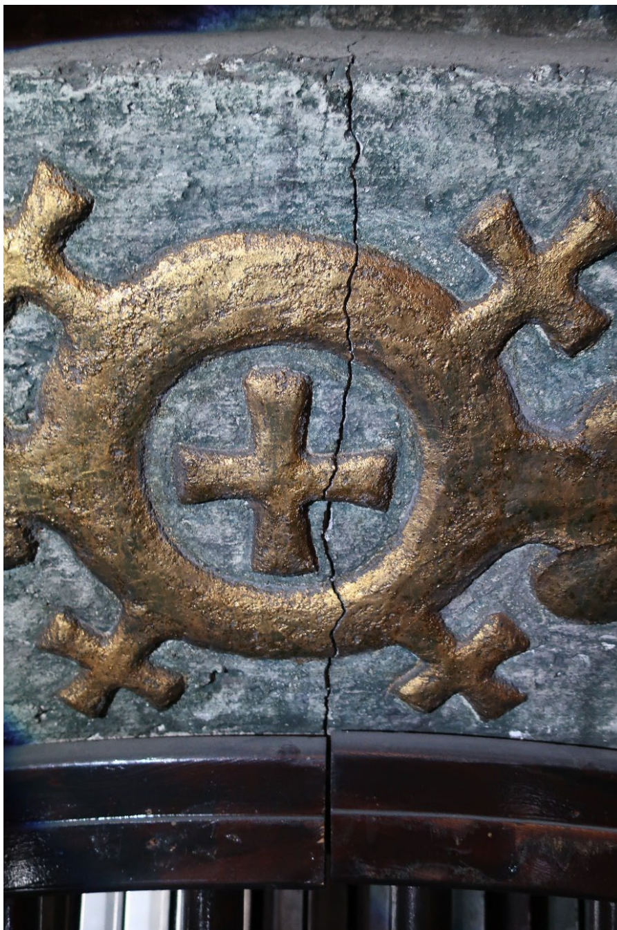
Figur 21 Sprekk (sannsynligvis setningskade) i rankedekoren under felt 4. Sprekken er stabil.
