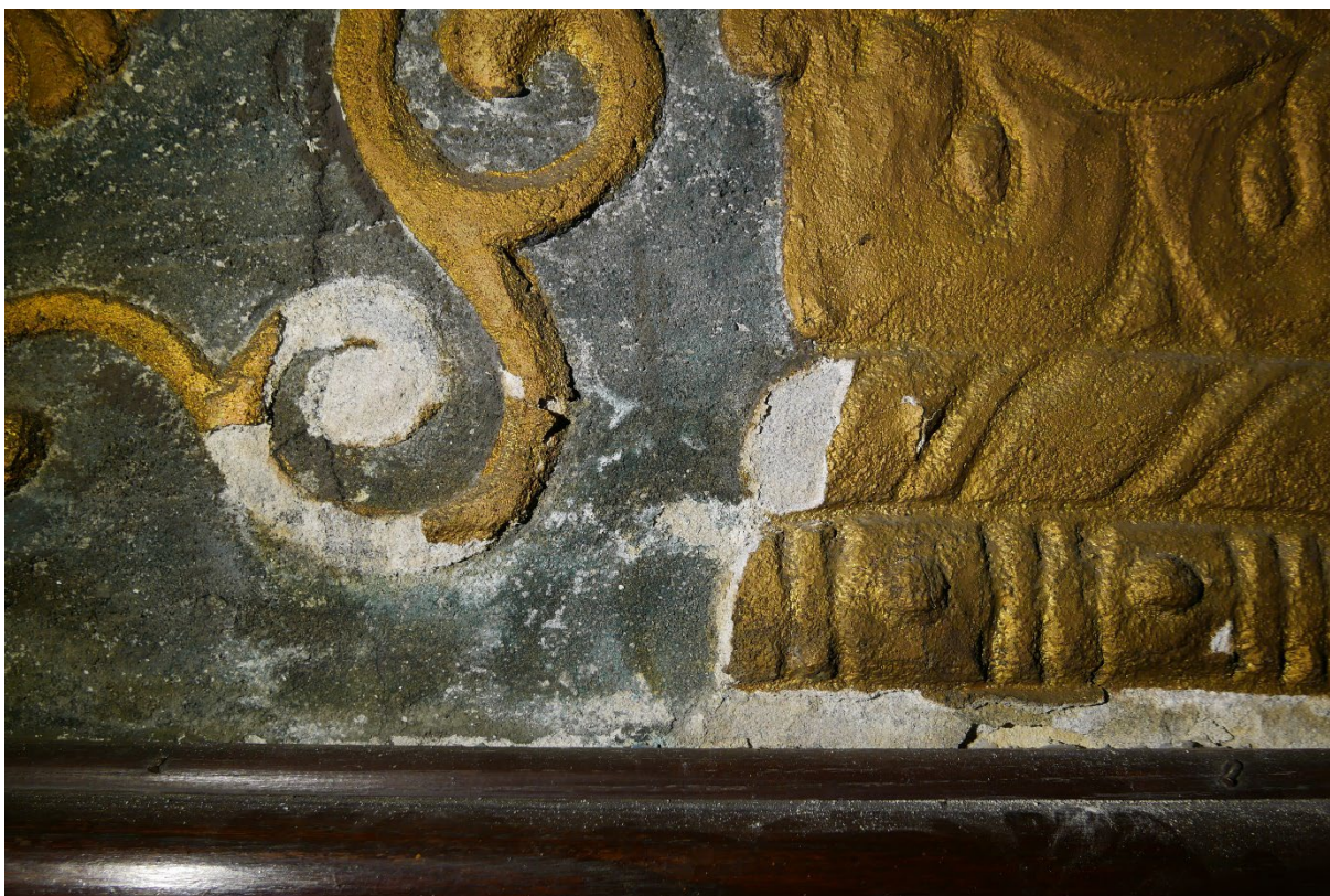
Figur 11 I skadde områder i buen i katafalken ser man en kornete smuldret stukkaturpuss, som har drysset ned på listen under.
