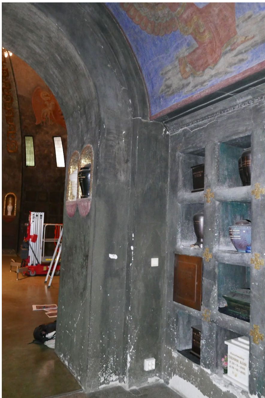
Figur 29 Nedre del av østre kolumbarium. Her ser man tap av materiale, særlig i nedre del, i tillegg til sprekker i øvre del.
