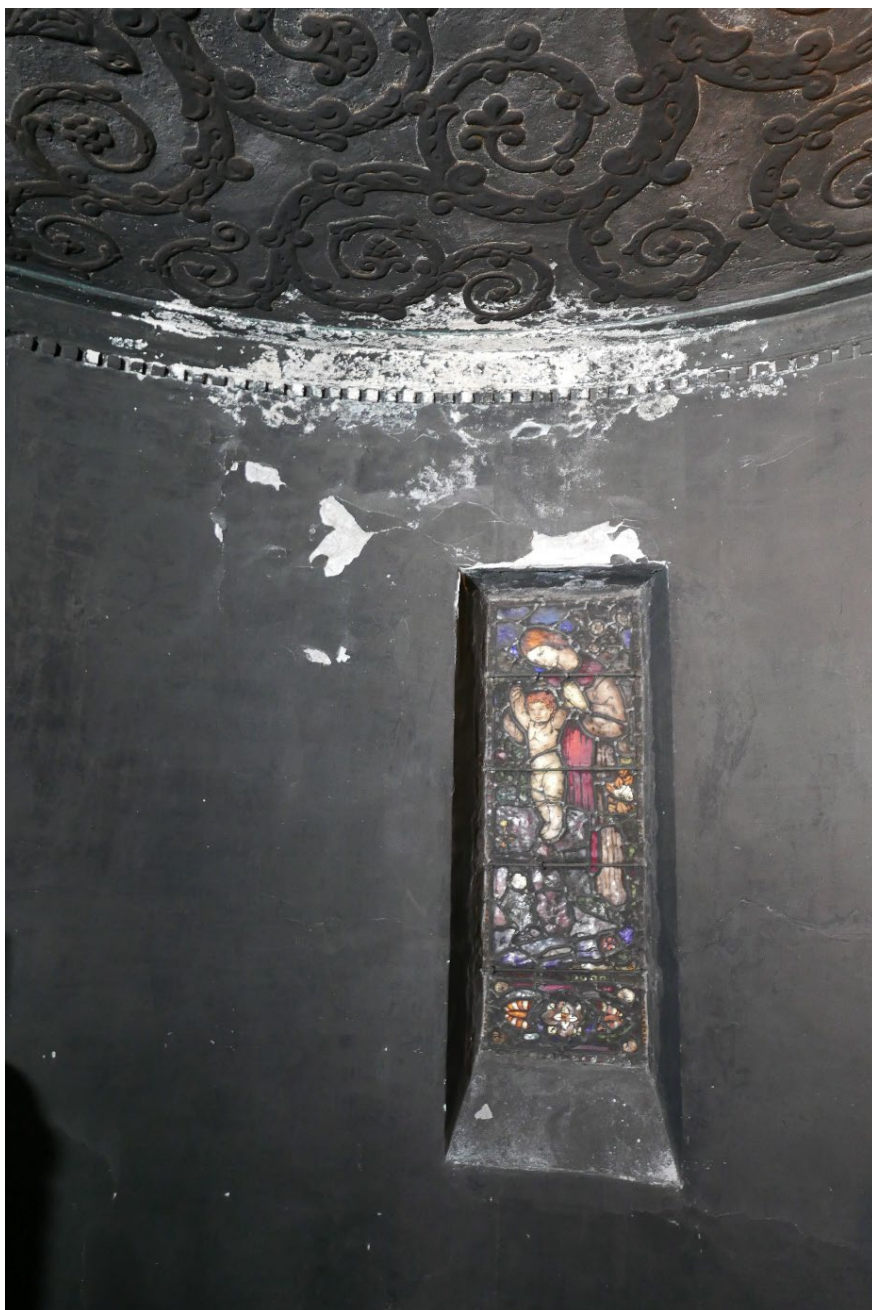
Figur 24 Større skade på vegg og himling i østre kolumbarium er et resultat av en tidligere vannskade og saltutblomstringer.
