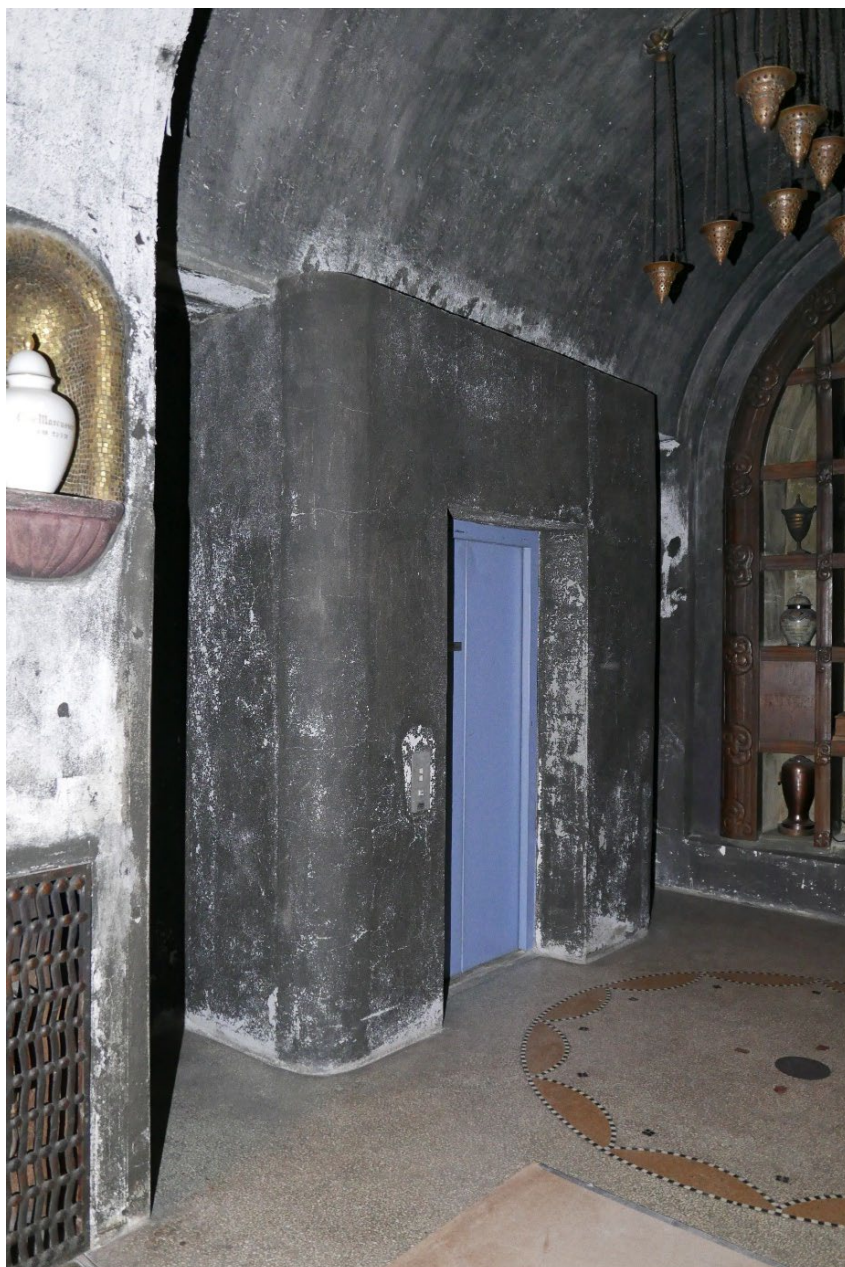
Figur 32 I vestre kolumbarium har malingen flasket av, og det er sprekker i muren.
