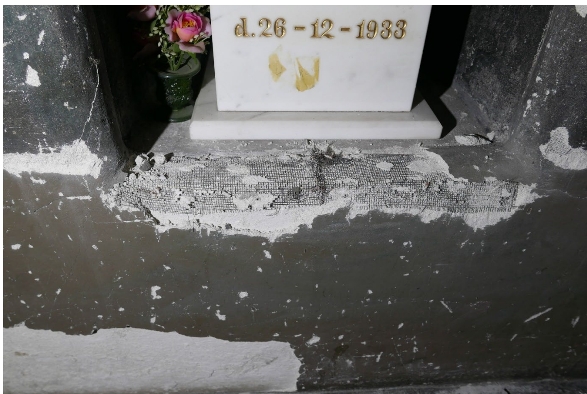
Figur 30 Større skade i hylle på bakkenivå i østre kolumbarium. Denne er utsatt og bør repareres.
