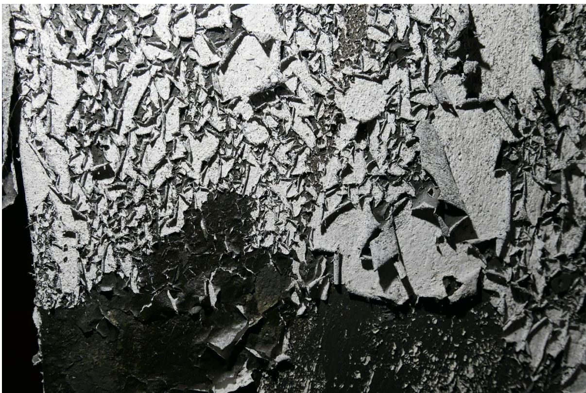
Figur 33 Detaljbilde av avskallet maling i vestre kolumbarium. Måten malingen skaller av på tyder på bruk av en diffusjonstett maling.
