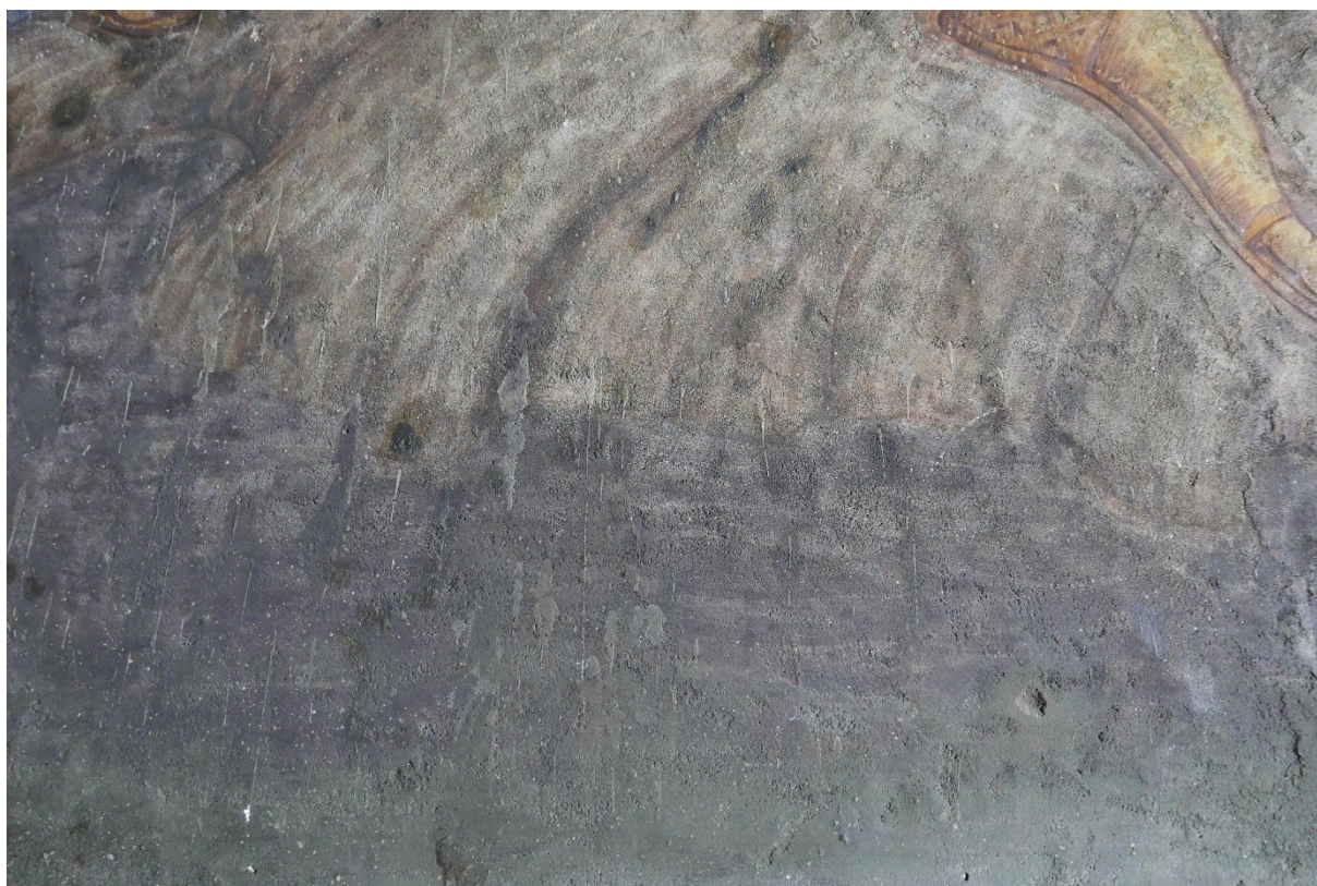
Figur 20 Flekker på overflaten i nisjen bak katafalken.
