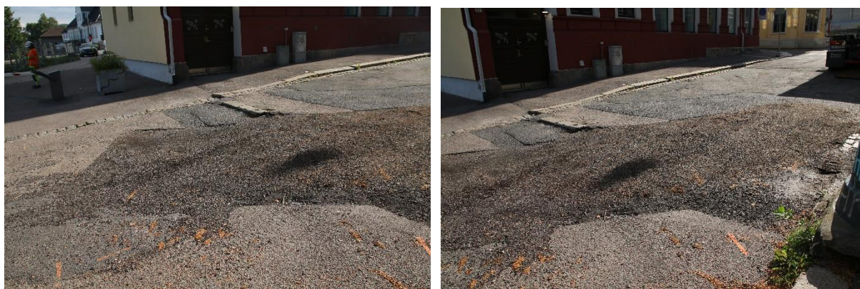
Figur 2: Tiltaksområdet før oppstart av gravearbeidet. T.v. sett mot nord. Foto: Cf55622_NIKU_01. T.h. sett mot nordøst. Foto: Cf55622_NIKU_02.
