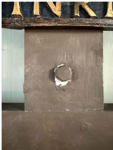
Fig. 11: Etter montasje. Utfallsområdet rundt skruen
