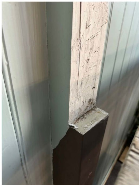
Fig. 3: Konsol der korsbjelken skal festes. Det ble tidligere brukt to spiker som ble sagt av ved de-montasje.
