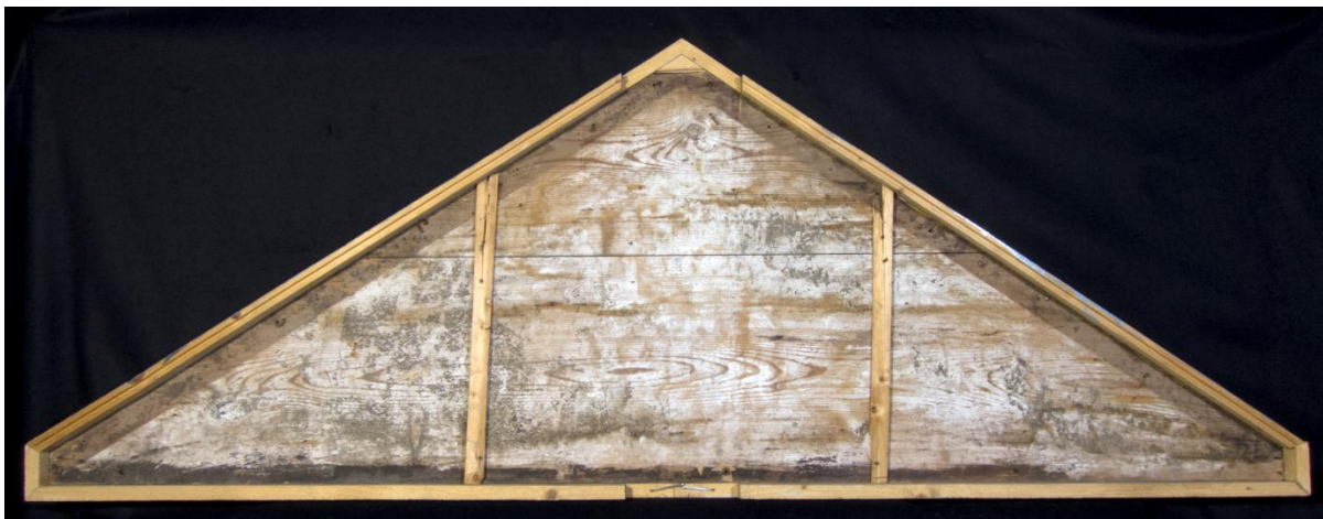
Ill 2: baksiden av gavlfeltet før behandling, 2012
