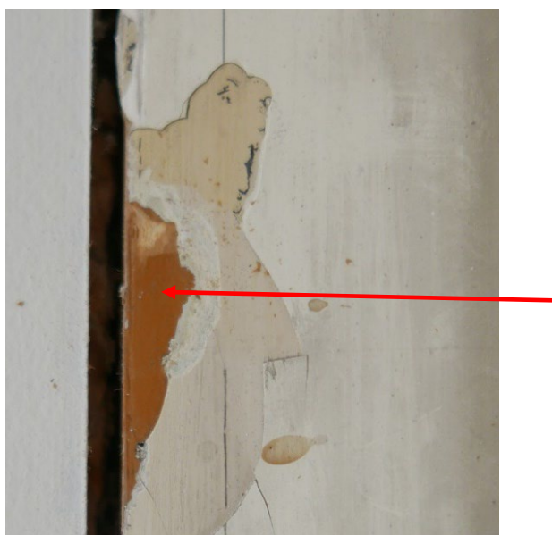
Figur 16 Eksponert opprinnelige malt gulbrun overflate på gerikt VB22.
