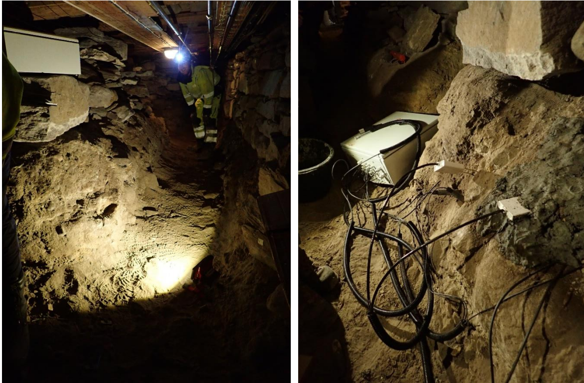
Figur 8: Tv.: Miljøprofil 2 før installasjon av sensorer. Sett mot nordvest. Foto: Sf223953. Th.: Sensorer installert i krypkjellerens midtgang mot øst, MP2. Sett mot sørøst. Foto: Sf223954.
