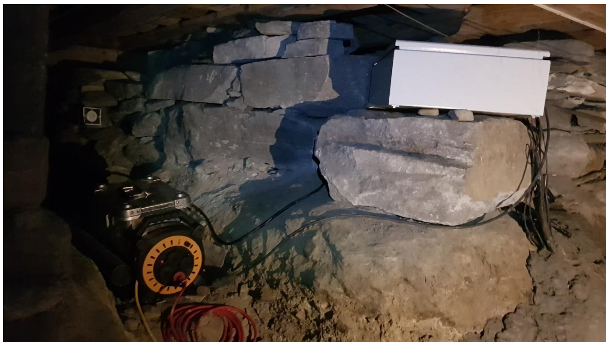
Figur 39: Måleskap ved miljøprofil 2 og batteripakke. Foto: Cautus Geo AS.
