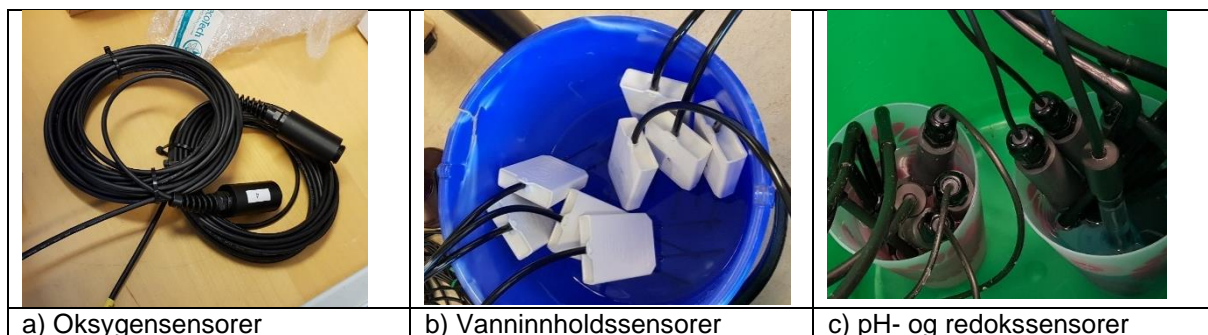
Figur 30: Bilder av sensorer som er installert i miljøprofilene under Stavanger domkirke. Foto: Cautus Geo AS.
