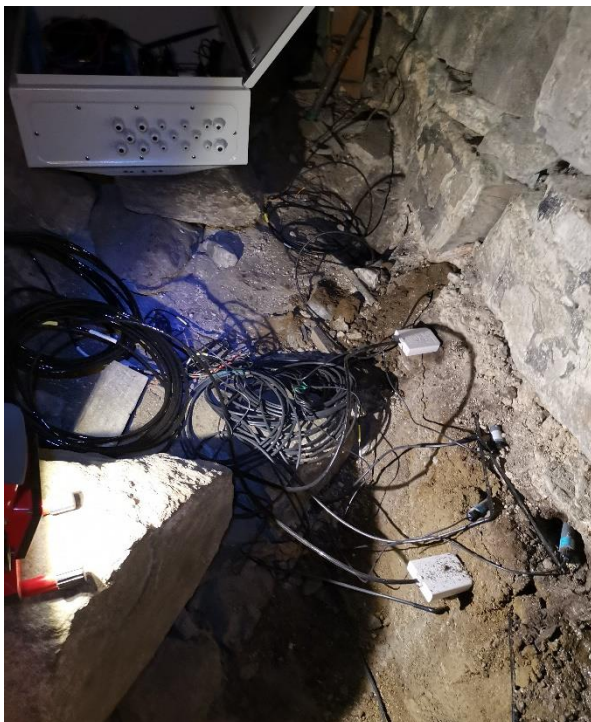
Figur 37: Installerte sensorer i miljøprofil 1, koblet til skap 1. Foto: Cautus Geo AS.
