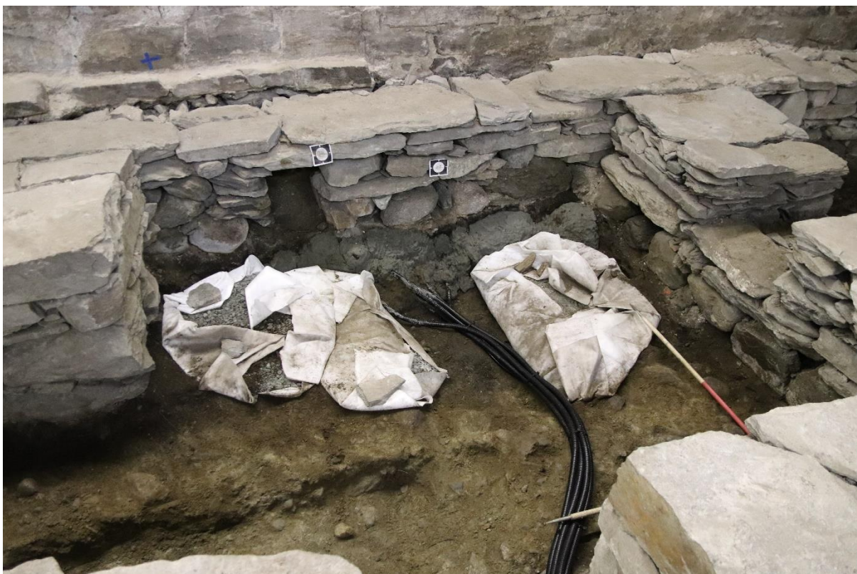
Figur 20: Miljøprofil 4 tildekket med leire etter ferdigstilt installasjon. Sett mot sør. Foto: Sf210417.
