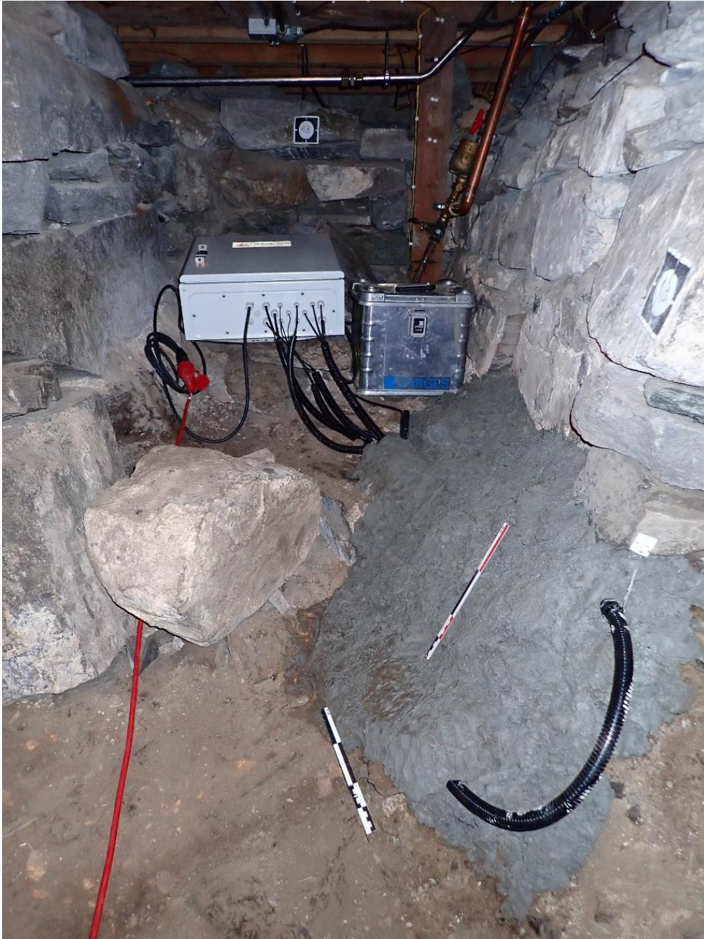
Figur 5: Miljøprofil 1 tildekket med leire etter ferdigstilt installasjon, samt ladbar batteripakke etablert som midlertidig strømforsyning. Sett mot vest. Foto: Sf223955.
