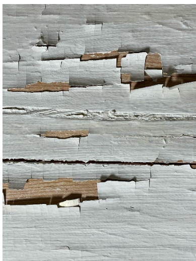
Figur 2 Avskallinger på drager. Foto:NIKU
