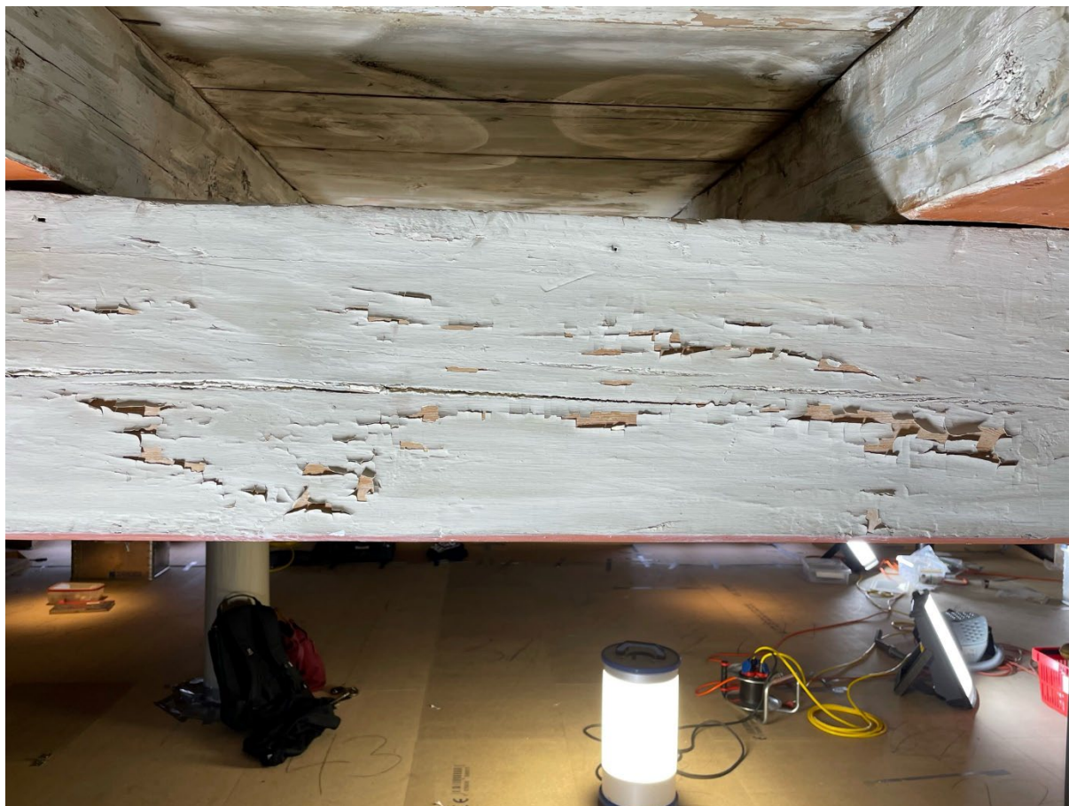
Figur 1 Avskallinger på drager. Foto:NIKU
