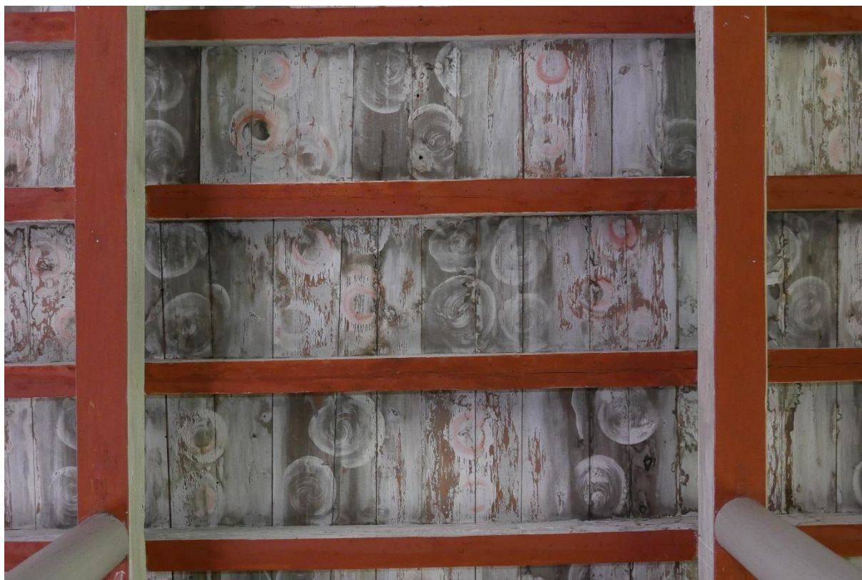
Figur 36 Midthimling før behandling. Foto: Wedvik/NIKU 2020
