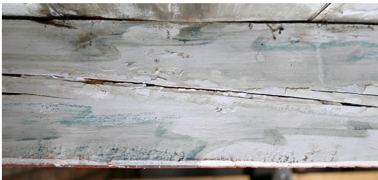
Figur 26 Detalj bjelke. Behandling 1930-tallet: Det ligger tørr, hvit sparkel i sprekke i treet, malt over med hvit vannfast maling. Man kan også se det som muligens er Ola Sæters retusjeringstester i blågrønt i mønsteret. Foto: Wedvik/NIKU 2021
