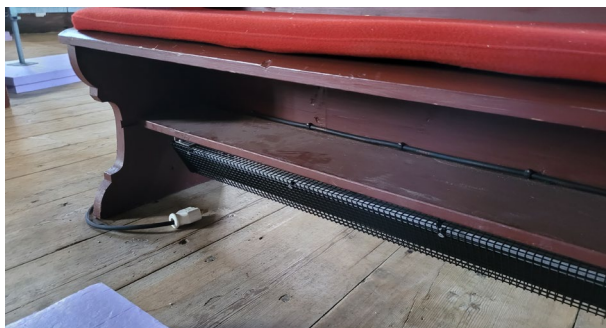
Fig.1. Rørovn under benk i skipet.
