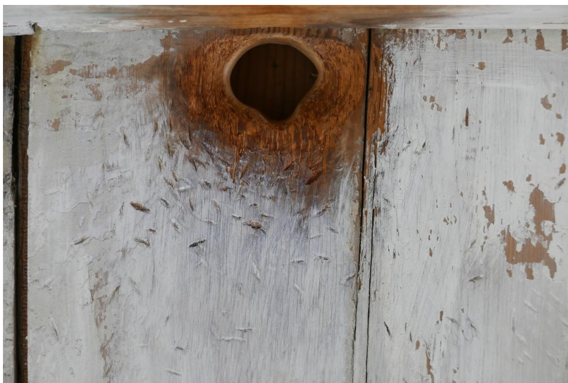
Figur 27 Himling. Hull etter klokkertau. Gamle mekaniske skader i malingen. Foto: Wedvik/NIKU 2022.
