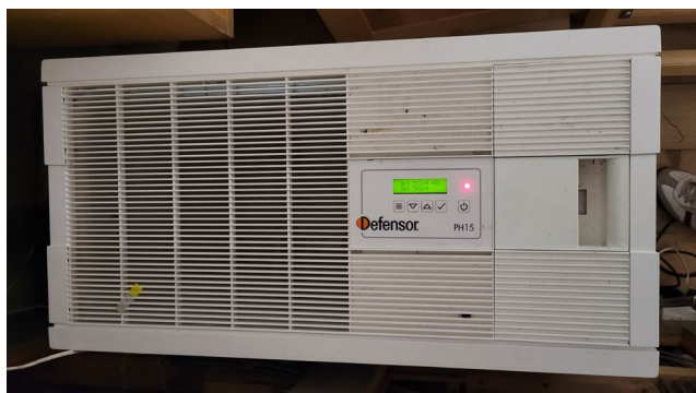
Fig.3. Luftfukter på galleriet. Bilde tatt ovenfra.
