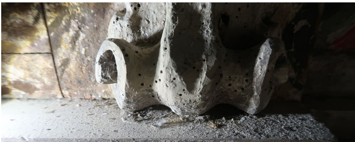
Figur 14 Mange borehull etter borebiller på lisene i 2. etasje.
