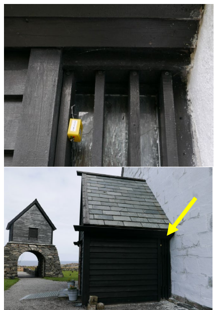
Figur 7 Klimalogger Kinn 6, utendørs, 2022. På sørsiden av våpenhuset.
