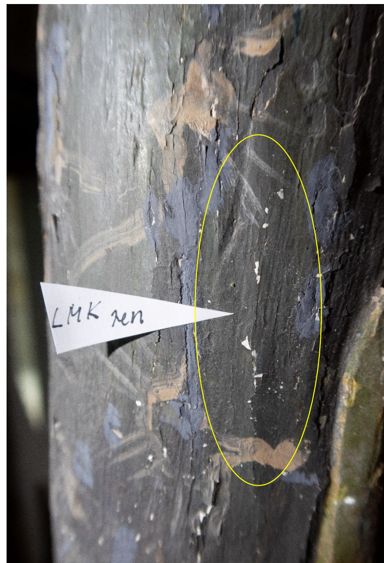
Figur 59 Testområde 4: Detalj av venstre søyle, innerst mot maleriet, Oppsprukket maling som løfter seg fra underlaget. Området i grønn oval er konsolidert med ren LMK.
