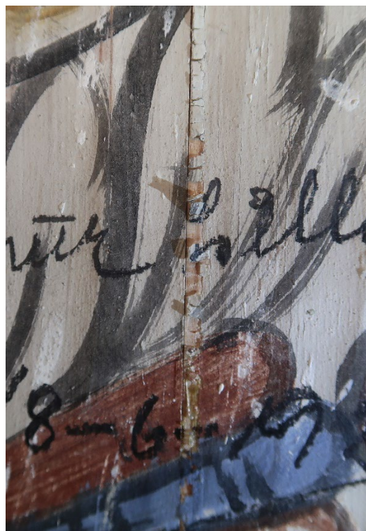
Figur 17 Detalj av baksiden av korpus. Oppskallende maling ved skjøten mellom to bord.
