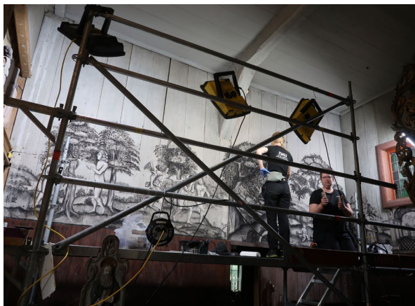
Fig. 59. Arbeidsbilde underveis i den visuelle reintegreringen av skader.
