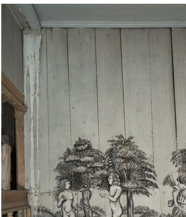
Fig. 36. Vannskade fra taket på venstre side av nordveggen.
