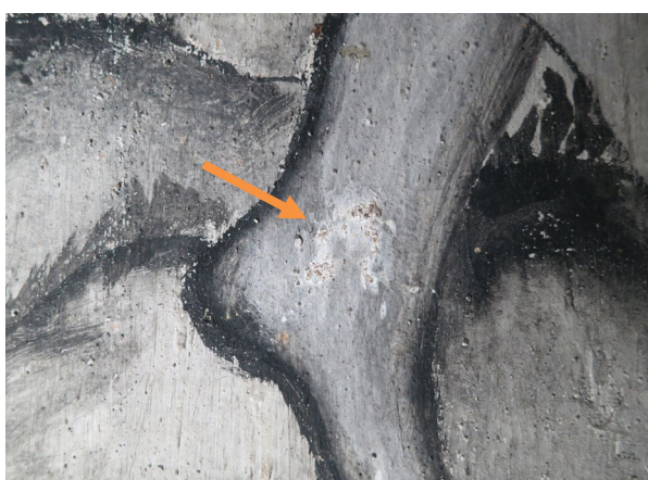
Fig. 40. Detalj av fugleskitt på nordveggen.
