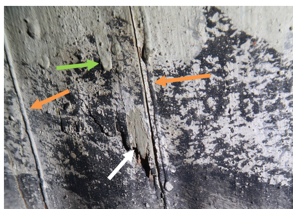
Fig. 13. Detalj av skade med synlig grundering (hvit pil) i nedre halvdel av nordvegg. Det er noen synlige, tykke renn av grundering dekket med sort og hvit farge (oransje piler), og noe renn av sekundær maling over den sorte og hvite fargen (lys grønn pil).
