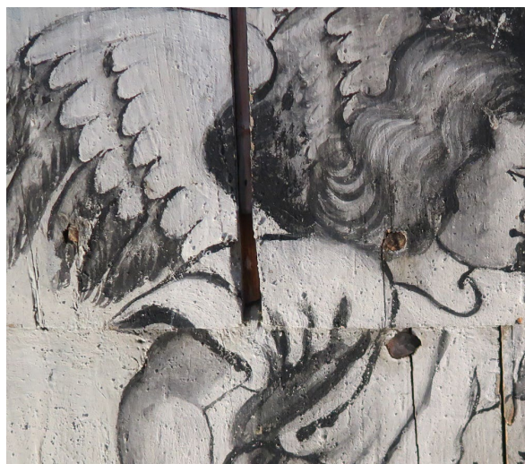
Fig. 27. Detalj av mellomrom mellom to paneler og sprekker i treverket.
