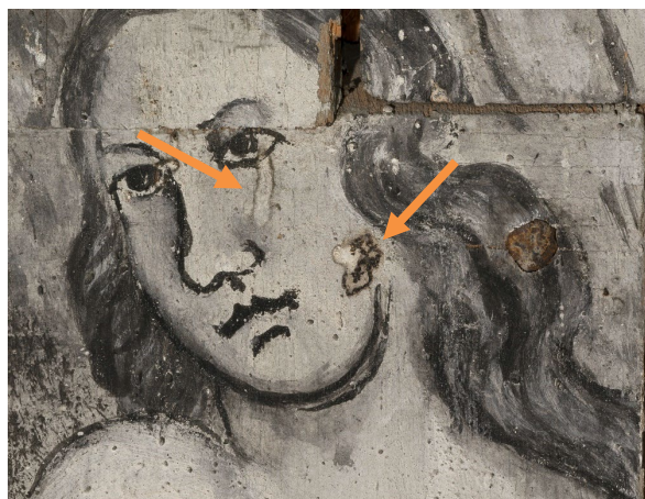
Fig. 39. Detalj av fugleskitt og skjolder i aniktet til Eva på nordveggen.
