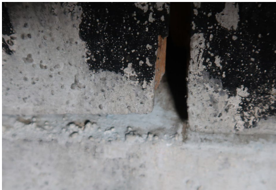
Fig. 19. Detalj av lys blågrå overmaling, med et område mellom to paneler hvor blåfargen er bedre bevart. Nordvegg.
