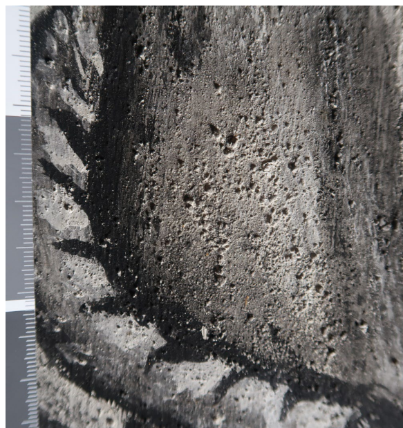
Fig. 16. Detalj av krittklumper i den hvite malingen. Nordvegg.
