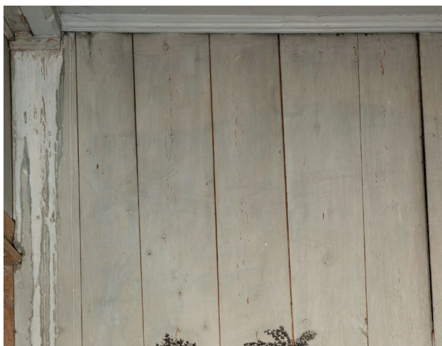
Detalj av venstre side av nordveggen, med vannskjolder fra vannskade. Før behandling.
