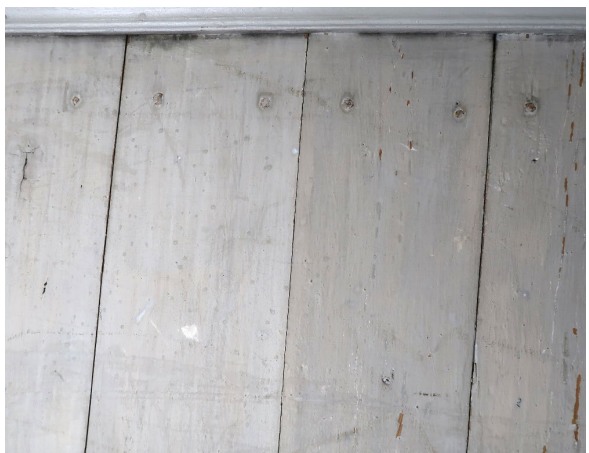
Fig. 56. Forskjell mellom overflaterenset område (to paneler til venstre) og område som ikke har blitt renset (to paneler til høyre).
