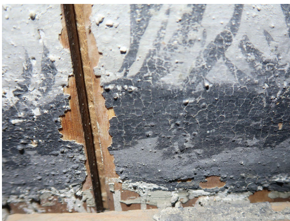
Fig. 32. Detalj av avskalling ned til treverket i nedre del av motivet i overgangen til brystningen på nordveggen.
