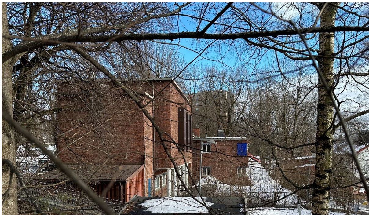
Figur 3-6 Nordre gavl og den karakteristiske fasaden med pilotis som henvender seg mot sørvest. Foto: KIMA
