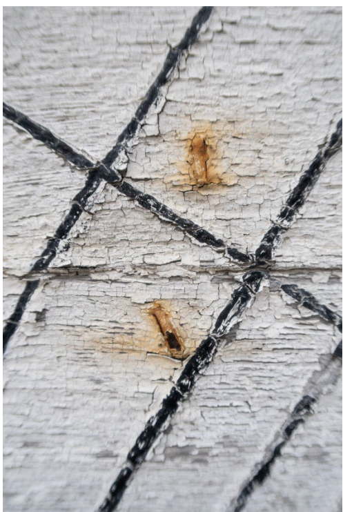
Figur 11 Spiker satt inn fra labanker på østvendt flate. Korrosjonen misfarger malingen på fremsiden. Foto: NIKU, Hulda Blix, 2020
