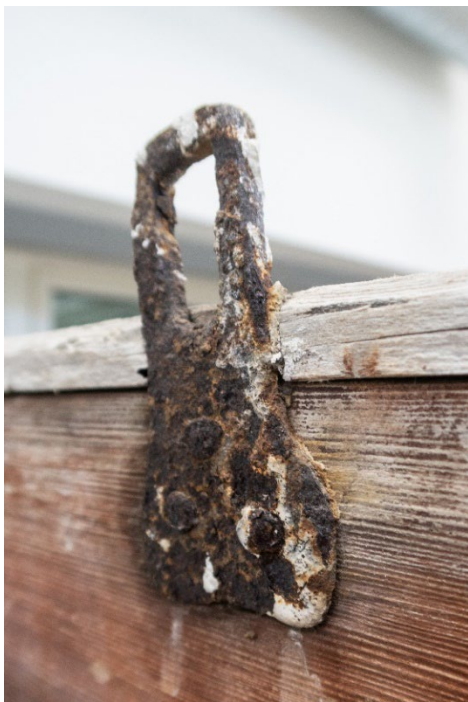
Figur 15 Metallhempe på østvendt flate. Korrodert men trolig stabil. Foto: NIKU, 2020.
