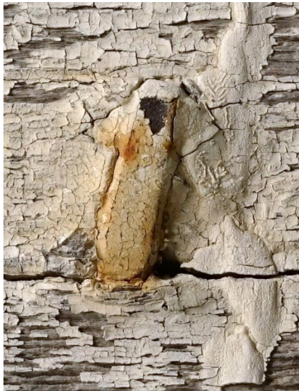
Figur 38 Rustflekker før rensing. Foto: MUHO Heleen van Santen
