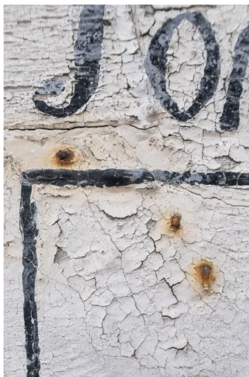
Figur 12 Spiker satt inn fra vinkeljern på østvendt flate. Korrosjonen misfarger malingen på fremsiden. Foto: NIKU, Hulda Blix, 2020.
