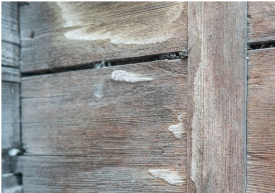
Figur 5 Saltutslag på baksiden av sørvendte flate. Foto: NIKU, Hulda Blix, 2020
