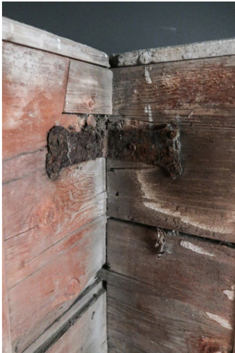
Figur 13 Øverste vinkeljern. Korrodert, men form og funksjon er intakt. Foto: NIKU, 2020.
