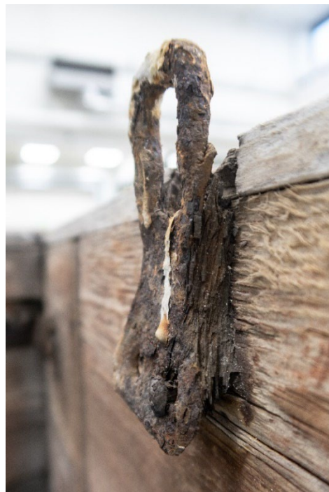
Figur 16 Metallhempe på sørvendt flate. Kraftig korrosjon. Foto: NIKU, 2020.
