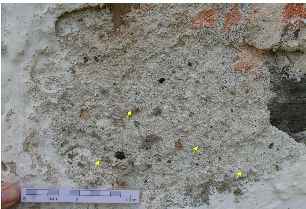
Figur 16: Skjellsandpuss (fase II) med nedbrutt overflate, der man kan se skjell i tilslaget (piler).
