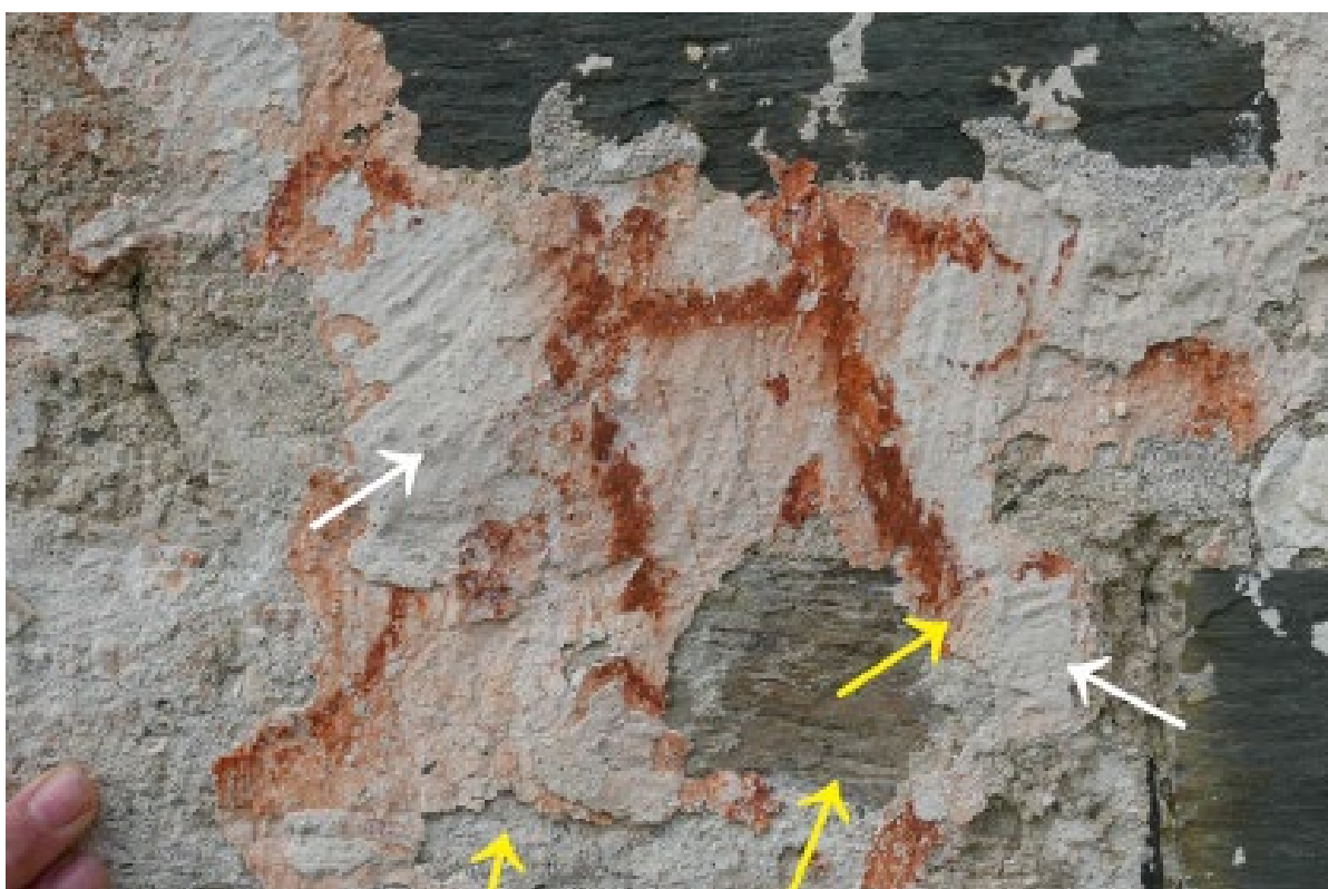
Figur 22: Merker på korets nordfasade, detalj. Gul piler viser løs slemming og avskallinger. Hvite piler viser gjenværende rester av overkalkingslag. Foto: Susanne Kaun.
