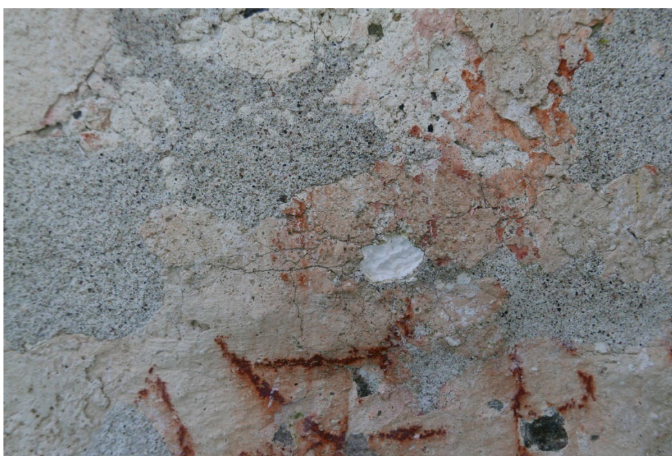
Figur 22: Spor etter tidligere behandlinger. Kitting fra 1974 (gul pil), og det som antakelig er rester etter injeksjonsmørte I (blå pil)
