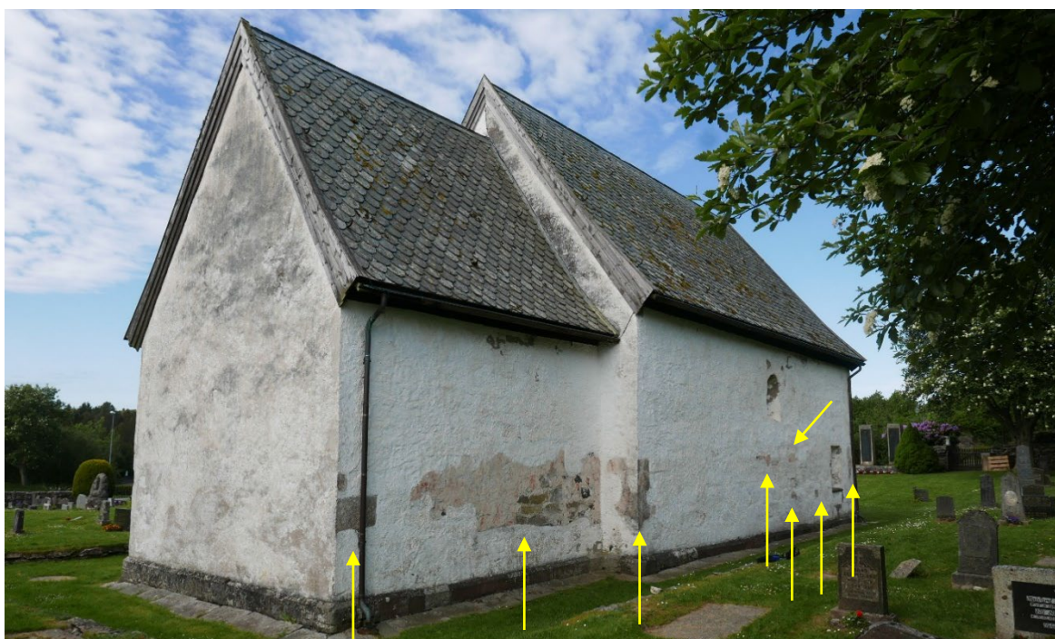
Figur 1: Moster kirke sett fra nordøst. Pilene viser veggfeltene med tegn og merker på kirkens nordfasade, og det store feltet er på korets mur. Foto: NIKU v/Susanne Kaun
