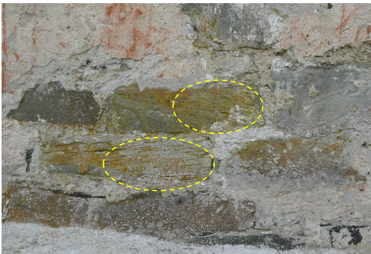
Figur 24: Stort område, der det nakne murlivet er synlig. Flere stein er begrodd med biologiske vekst. Innrissinger er merket med gult.
