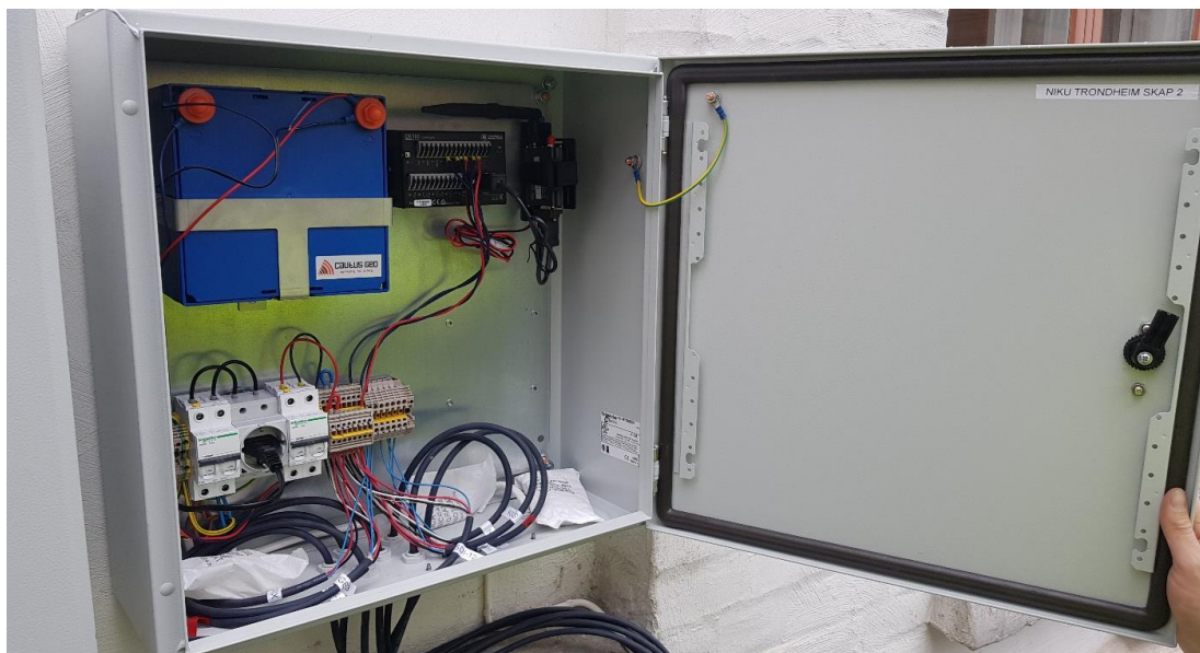
Figur 11. Ferdig montert skap, sett fra innsiden.
