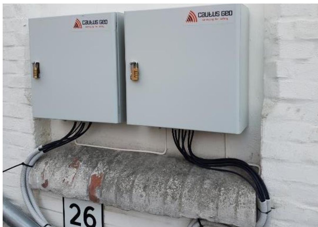
Figur 12. Ferdig monterte skap
