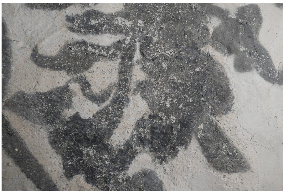
Figur 3: Flere avskallinger i malingslaget. Foto: NIKU
