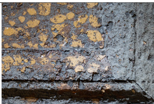
Figur 11 Brannskadede malingslag. Senere lag løsner, og man ser eikeådringen under.
