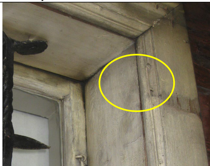
Figur 49 Foto av gerikt viser at vindu og gerikt kan være malt parallelt og ha de samme få fargelagene. Se negativt fargespor, første fargelag sees, innenfor gul sirkel.
