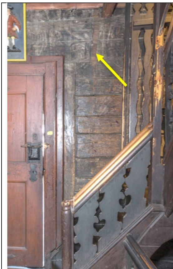
Figur 29 Negativt fargespor på vestveggen, markert med gul pil.
