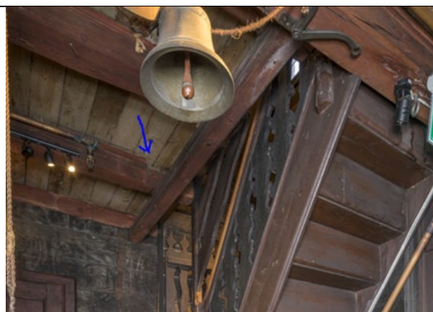
Figur 18 Himling og takbjelker over trappeløpet mellom 209 og repos. Notér at det er tatt ut i bjelken, der det er markert med blå pil. Har dette noe med trappen å gjøre?
