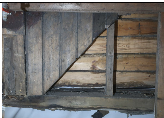
Figur 10 Nordvegg under repos og gulvet i første etasje dekket med hvit papp. Før reposit ble etablert har trappevingen fulgt panelets nedre kant med noe overlapp.
