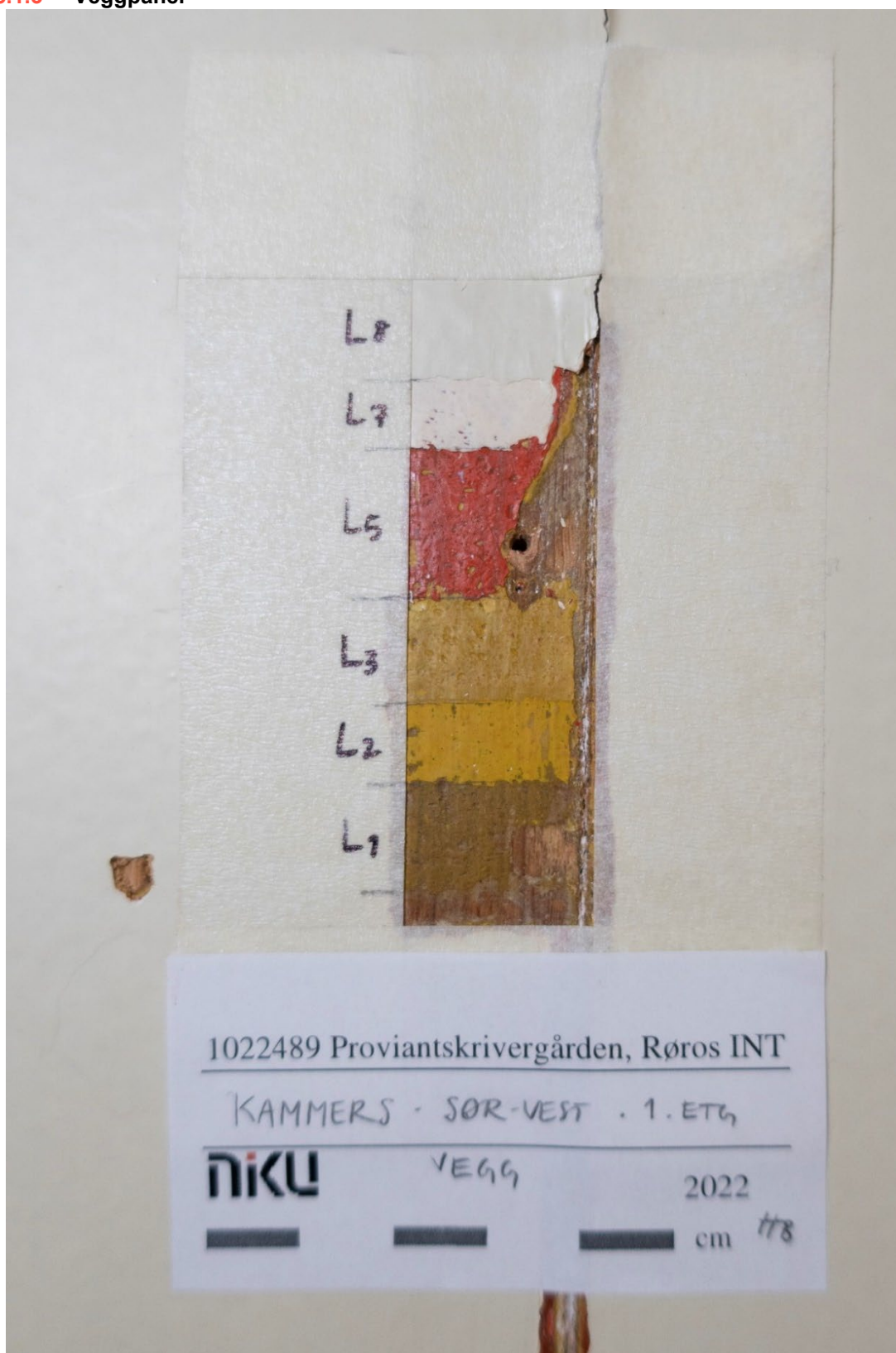
Figur 18 Lagvis avdekking på veggpanel mot sør. Avdekkingen er gjort ca. 150 cm opp på veggen, altså over brystningshøyden. De samme lagene er funnet på lettveggen mot nord. Avdekkingen viser ikke første grunningslag. Avdekkingen mangler også L4 og L6. Disse er avdekket i avdekkingen ved negativ fargespor etter brystningslist, i figur 21. Foto: NIKU, 2022.
