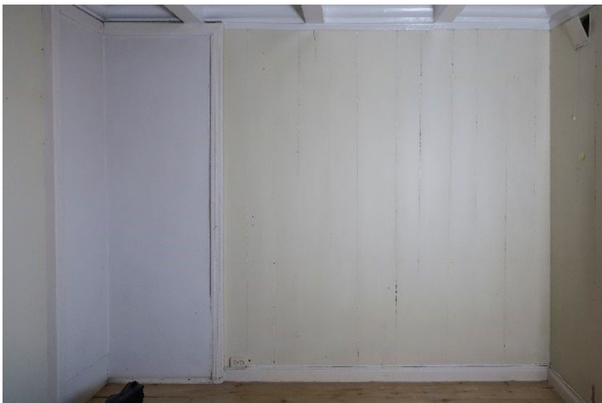
Figur 4 Vegg mot øst. Brannmur til vestre. Brannmurslisten har riflet profilering, og er antakelig satt inn samtidig som dørgerikta. Foto: NIKU, 2022.
