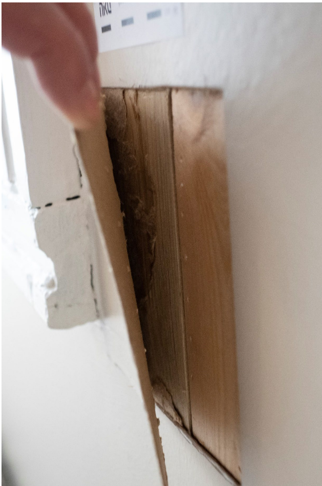
Figur 42 I åpningen på vestveggen ble det funnet sekundære veggbord. Disse er satt opp samtidig som platene ble montert, og det er ingen malingslag eller tapetlag på disse. Ifølge brev fra Riksantikvaren til tidligere eier Eli Høsøien ble det utført reparasjoner på utvendig panel mot gaten mellom 1948 og 1952. Panelet skal ha blitt skadet fra bombesplinter etter bombing i 1940. 8 Foto: NIKU, 2022.
