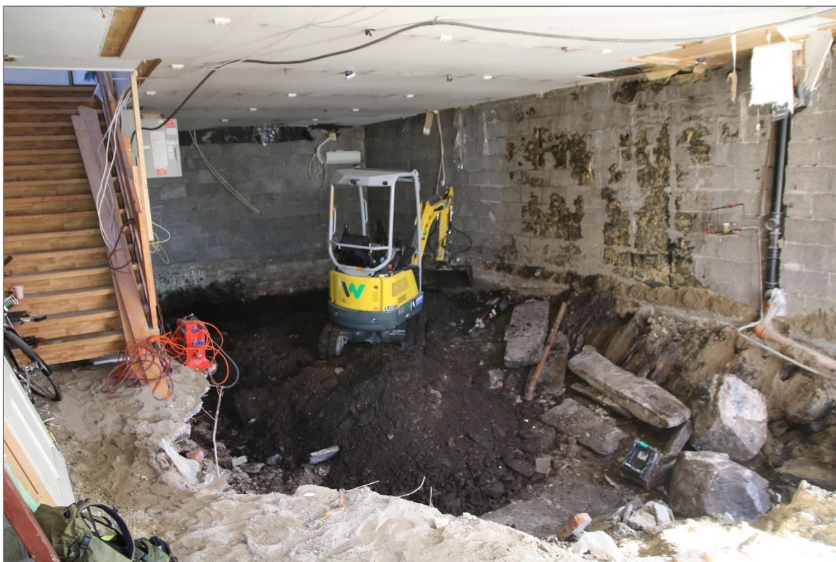
Figur 2. Bilde som viser graving inne i byggets første etasje. De store blokkene av naturstein er det som er igjen av de opprinnelige veggfundamentene.
