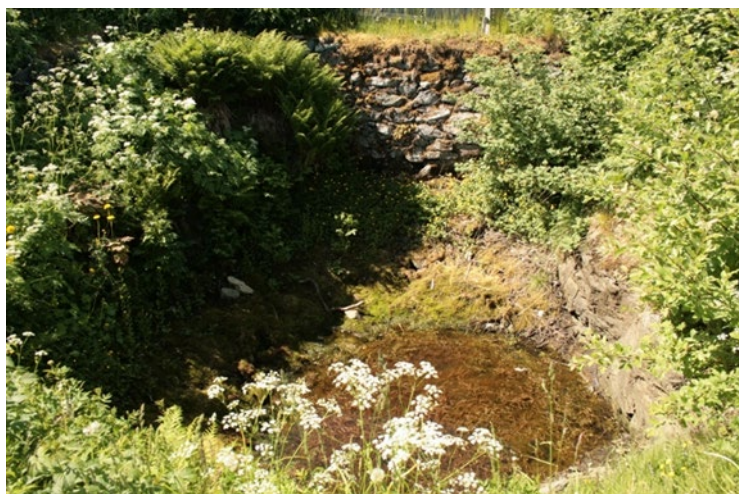
Figur 2. Situasjonen i brønnen ved befaring i juni 2014. bildet er tatt mot vest og viser tett vegetasjon i alle sider og mye vannplanter i vannspeilet. Fjellveggen synlig i den nordre side og i øvre del av vestre side vises en murt forsterkning som er antatt å være fra okkupasjonsårene. Foto: NIKU.
