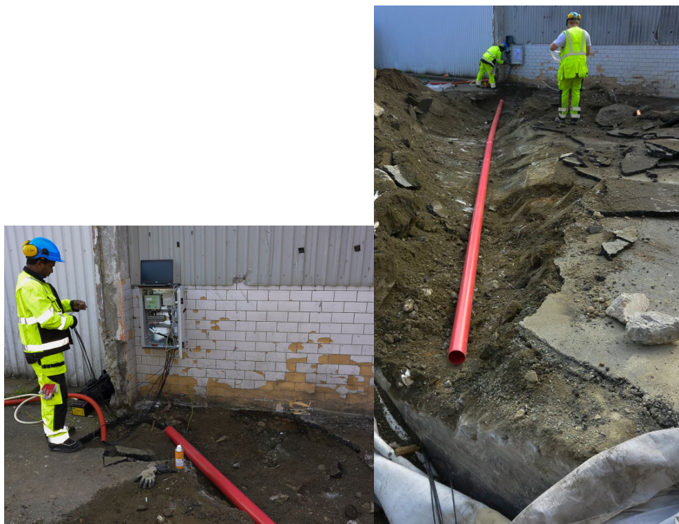
Figur 12a og b. a) Skap med datalogger montert på husvegg, b) grøft med kabler i rør. Foto: NIBIO.
