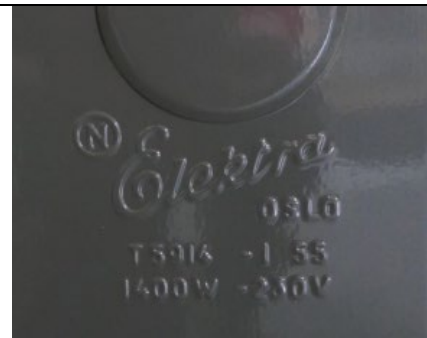
Informasjon på panelovner i koret
