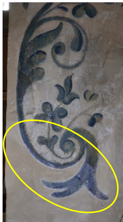
Figur 7: Ulnes kirke. Detalj fra rankedekor rundt døråpning med større reparasjoner (merket). Foto: NIKU/ Kaun
