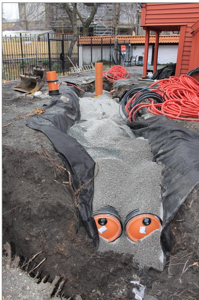
Figur 16: Mellomlagringsrør, Schøtstuene (Dunlop, NIKU).
