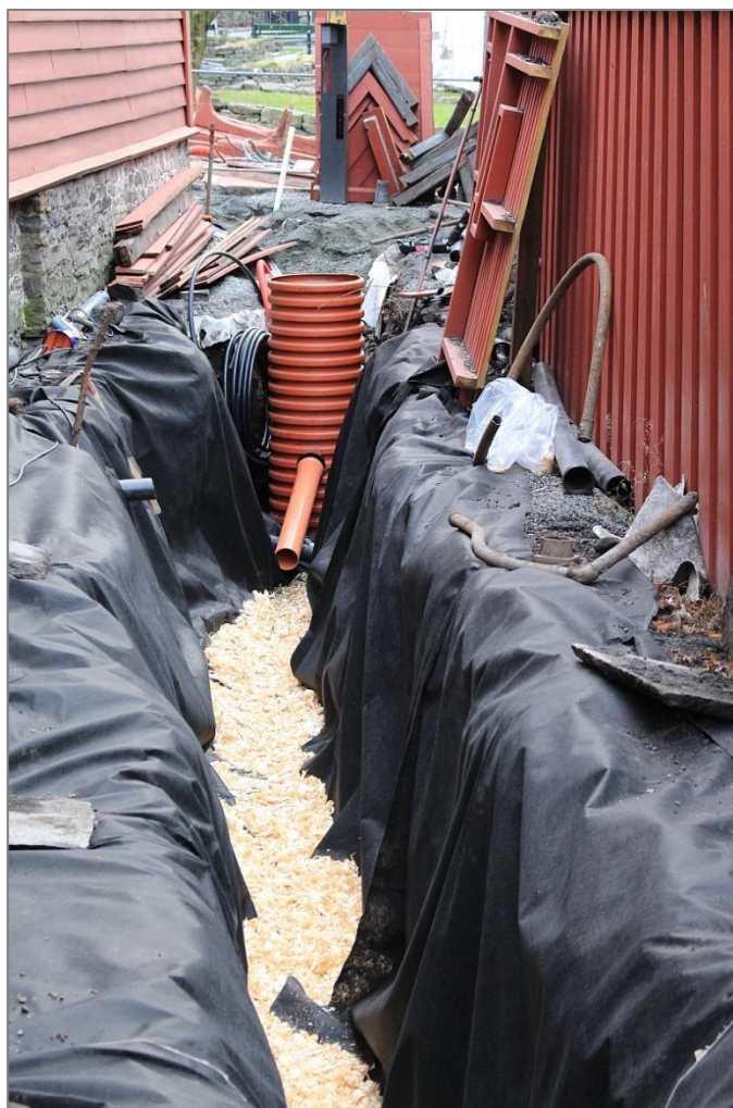
Figur 5: Oversikt av treflis/-spon på bunnen av I/T-system-grøft, Bryggen (Dunlop, NIKU).
