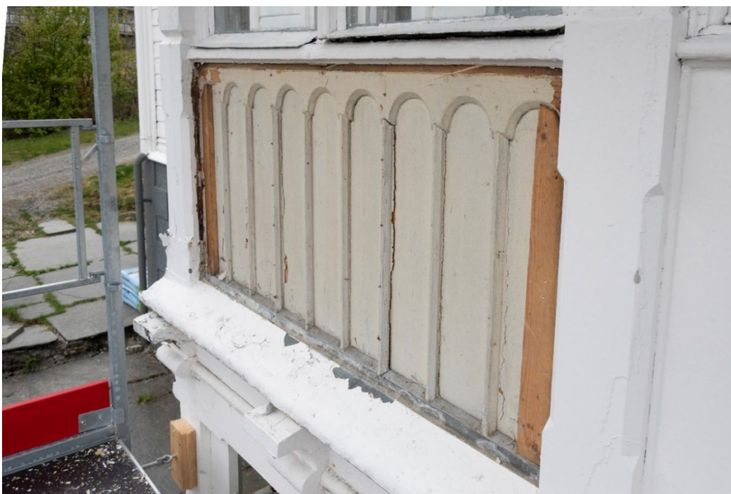
Figur 31 Etter fjerning av plater under vinduene i 1. etasje på glassverandaen. Foto: NIKU, 2022.
