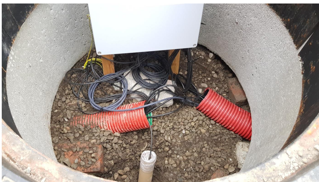
Figur 10. Ferdig montert kum. Øverst i bildet: Koblingsboks plassert i kum. Midten: trekkerør for sensorkabler. Under: Referansesonde for pH- og redokssensorer.
