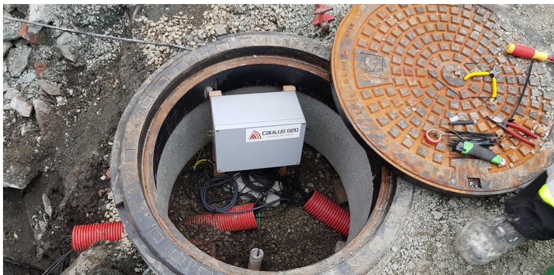
Figur 9. Koblingsboks i kum ved miljøprofil 3.
