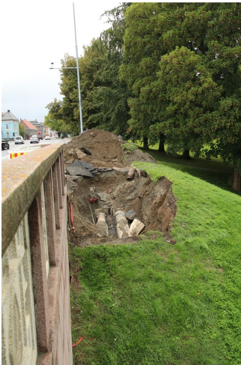
Figur 2. Fjernvarmelekkasje på nordøstsiden av Elgeseter bru. Foto: NIKU.
