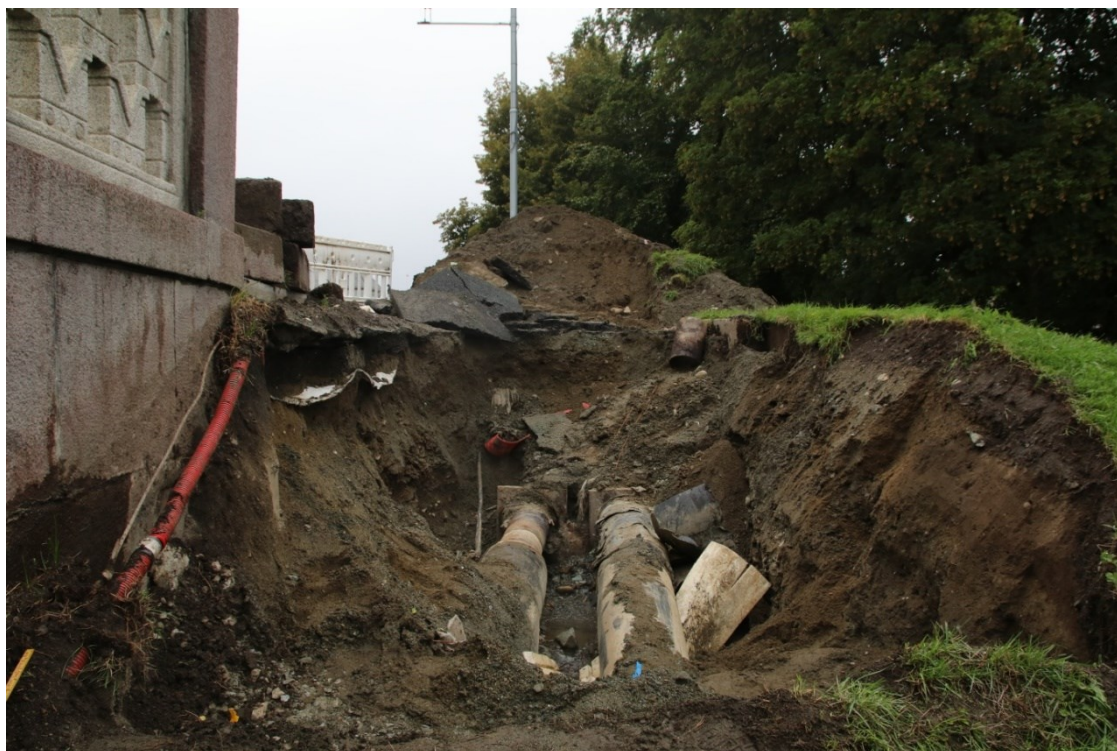
Figur 3. Fjernvarmelekkasje på nordøstsiden av Elgeseter bru. Foto: NIKU.
