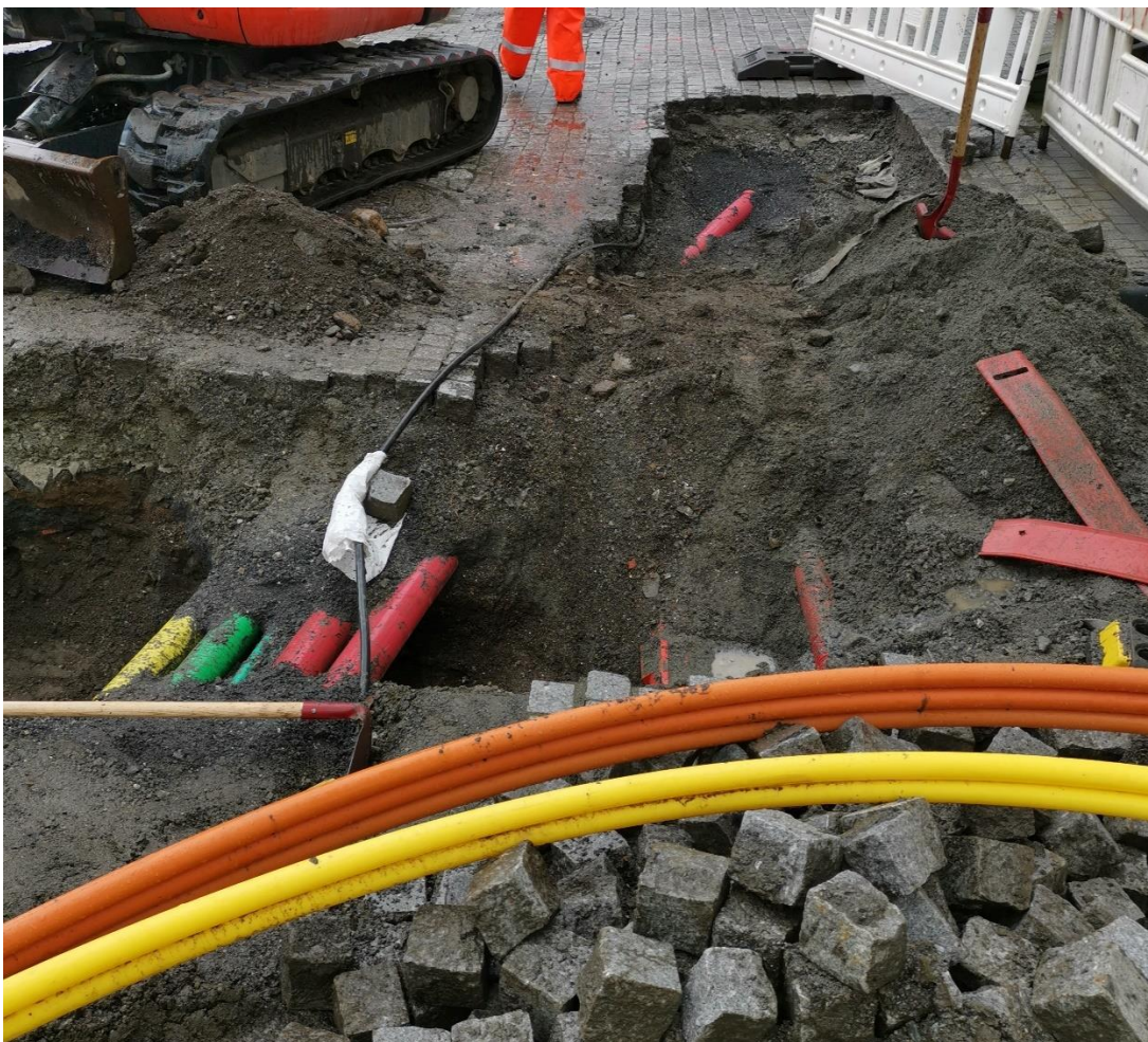
Figur 7: Moderne rør og kabler helt Ø i grøften og rett Ø for Tollbodgaten 13. Foto: Alma Thuestad, NIKU.
