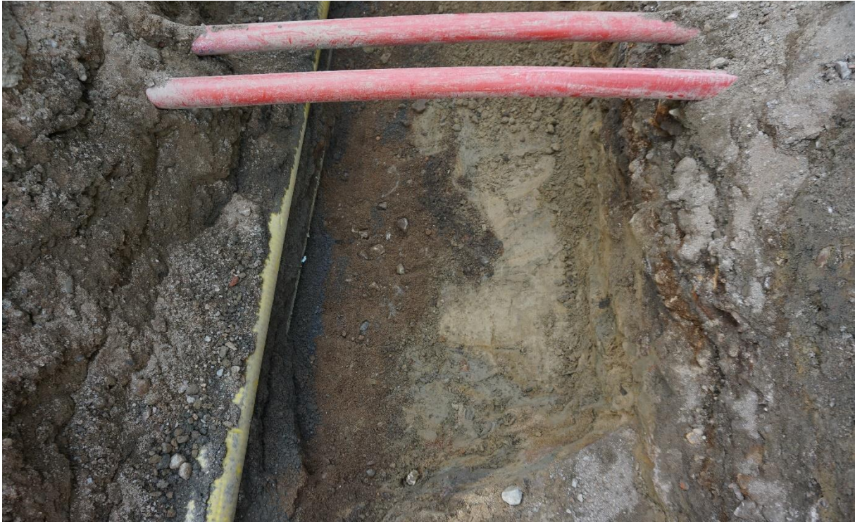
Figur 6: Moderne rør og kabler. Gule rør til venstre i bildet følger grøften i S. Foto: Alma Thuestad, NIKU.
