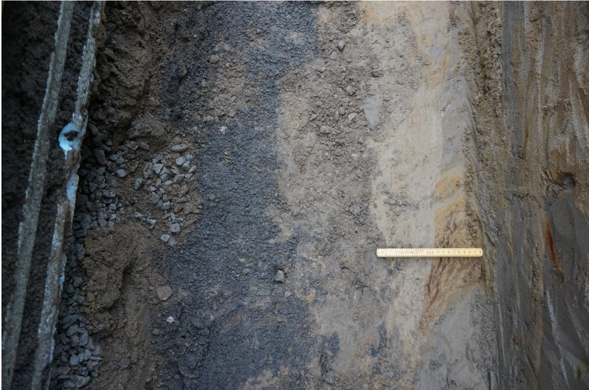
Figur 9: Bunn av grøft med rør, kabler og påfylte masser i sørlig del av grøften (til venstre i bildet). Foto: Alma Thuestad, NIKU.
