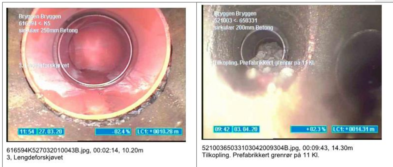
Figur 10. Venstre: Eksempel på lengdeforskyving i skjøyt. Høyre: Eksempel på sand og grus i rør. Vitek AS
