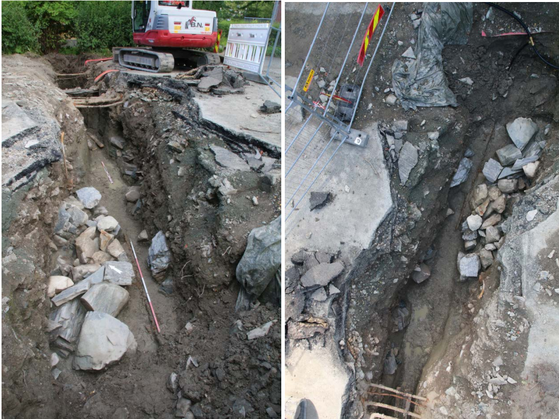
Figur 44: Sjakt 11 inneholdt et massivt steinfundament og intakte kulturlag i begge profiler. Venstre: Sjakta sett mot nord-øst, toppen av sjakt 4 kan ses helt nederst. Høyre: Sjakta sett ovenfra mot sør-vest med sjakt 4 helt øverst. Da62836_545 og Da62836_540.
