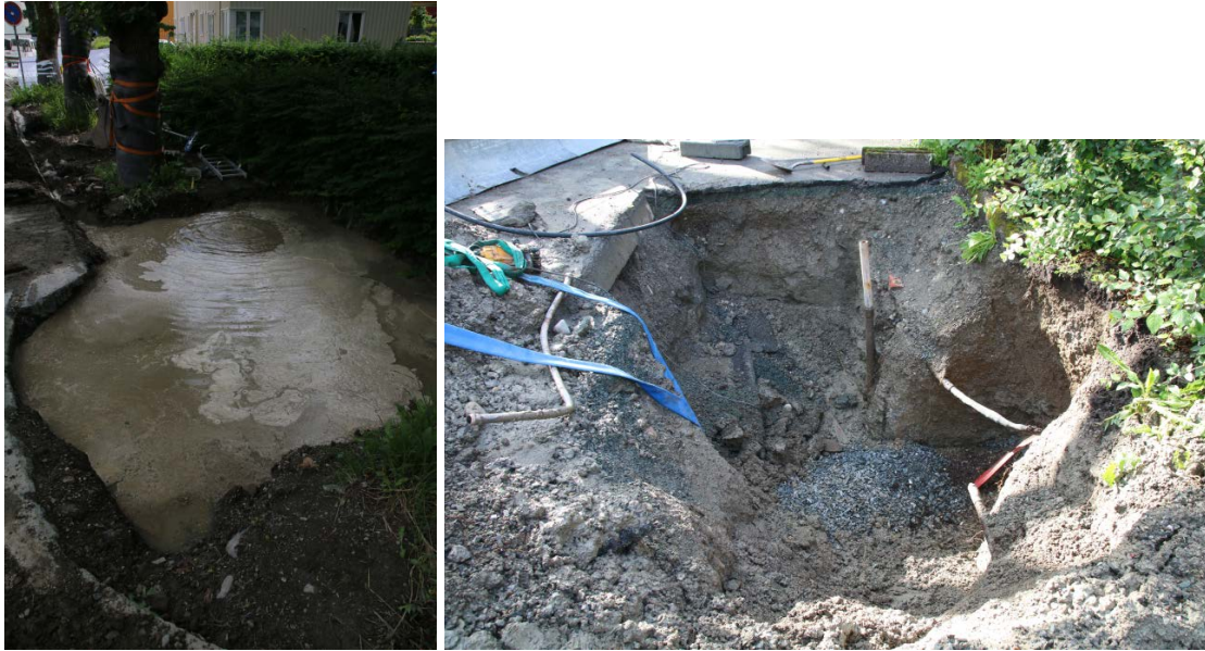
Figur 11: Graving i nærheten av aktive vannledninger bød på enkelte utfordringer. Venstre: Oversvømt sjakt 6. Høyre: En sammenrast sjakt 3 med pumpe slang til venstre i bildet. Da62836_320 og Da62836_155.
