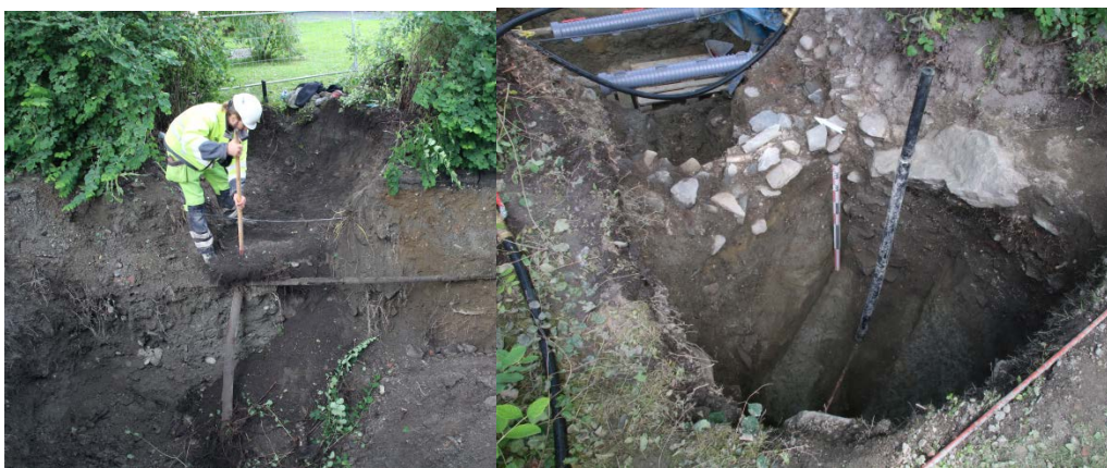
Figur 13: Utvidelse av sjakt 5 mot sør. Venstre: Mot hagen til Klostergata 47, sett mot sør. Høyre: stripe med intakte kulturlag med påkoblingshull stikkende opp til høyre i bildet, sett mot nord-øst. Da62836_307 og Da62836_503.
