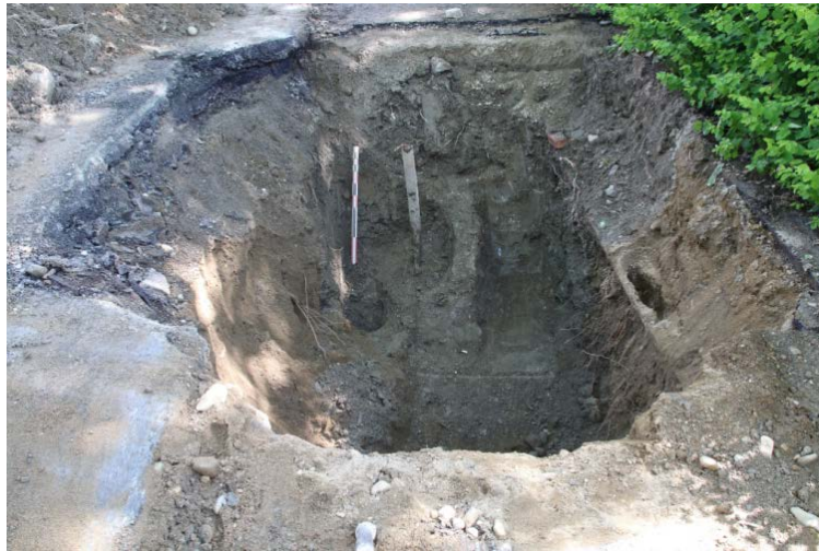
Figur 25: Sjakt 5 med opprinnelig størrelse. En bolke med antatt intakte kulturlag ble avdekket øst i sjakta (midt i bildet). Dette viste seg å være omrotede masser. Sett mot øst. Da62836_048.
