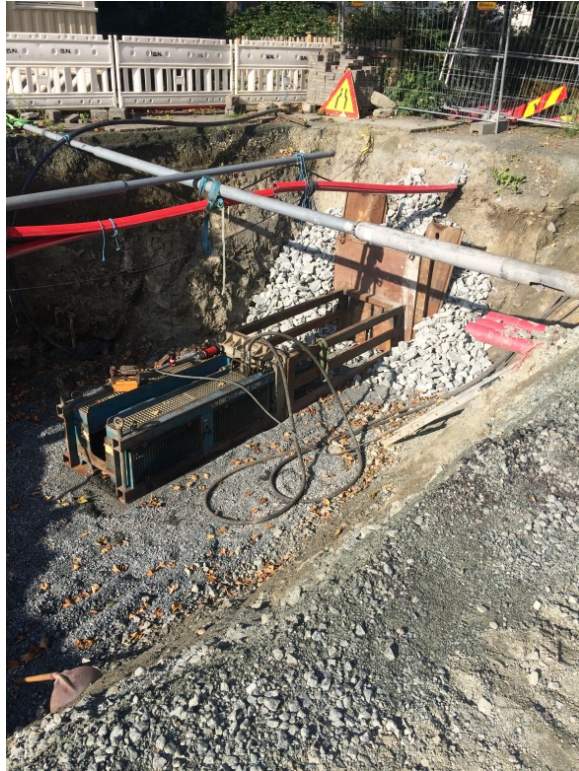
Figur 34: Sjakt 7 var en trekkgrøp der hovedvannledningen skulle trekkes fra, gjennom Klostergata. Sett mot sør-vest. Foto: Reidar Øiangen, privat.
