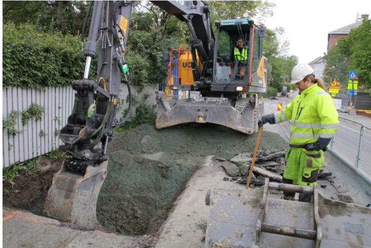
Figur 3: 13 hull/sjakter ble gravd i Klostergata for å komme ned til påkoblingspunkter og stikkledninger til hovedvannledningen, her ved sjakt 1. Sett mot nord-vest. Da62836_002.
