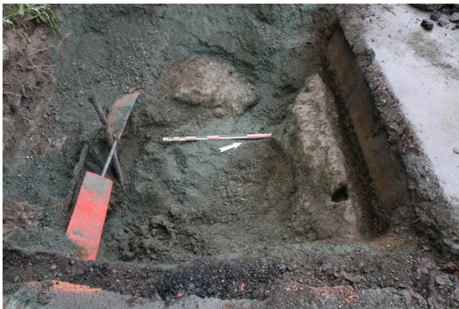
Figur 20: Sjakt 1 viste seg å være totalt forstyrret av moderne aktivitet. Sett mot nord-vest. Da62836_005.
