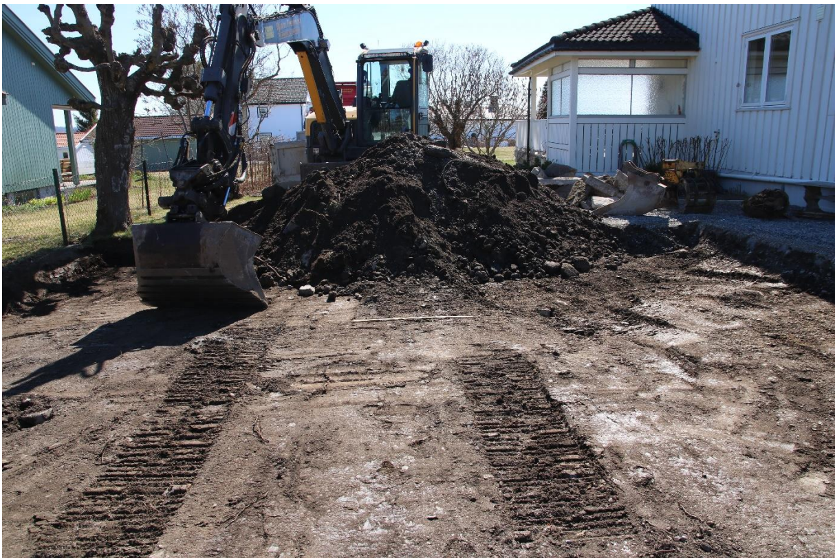
Figur 6: Ferdigstilt gravd grop for nytt fundament til garasje. Målestokk viser 1 meter. Sett mot sør. Foto: Cf53863_NIKU_14.
