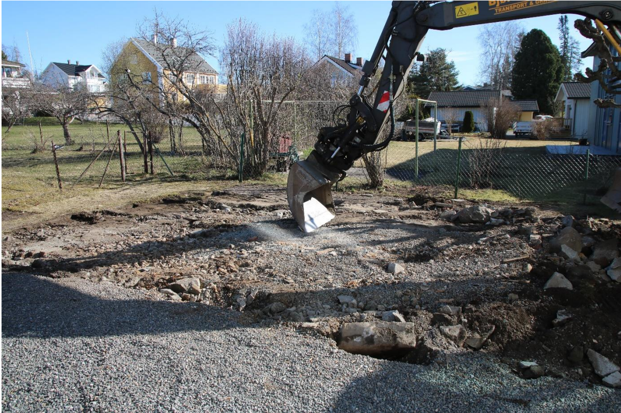
Figur 2: Tiltaksområdet før oppstart av gravearbeidet. Den eksisterende garasjen ble revet i forkant, og noe rivningsmasse lå igjen på tiltaksområdet. Sett mot nordøst. Foto: Cf53863_NIKU_02.
