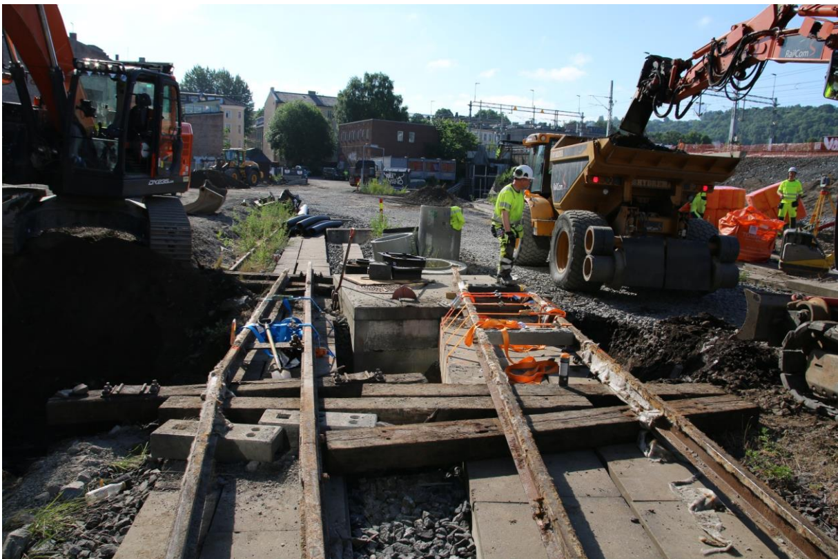
Figur 9: Moderne infrastruktur i form av kabelkanaler i betong gikk på tvers av grøft for overvannsledning. Disse ble stropet og undergravd. Sett mot øst. Foto: Cf53908_NIKU_46.
