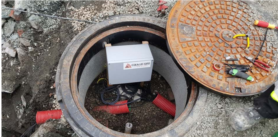
Figur 5.9: Koblingsboks i kum ved miljøprofil 3, sjakt 3
