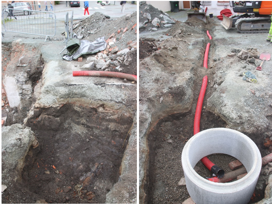
Fig. 2.5 Venstre: Hullet for kum ved miljøprofil 2. Sett mot NNØ. Da62837_045. Høyre: Kumhullet, kabelgrøften og loggerskapet. Sett mot VSV. Da62837_046
