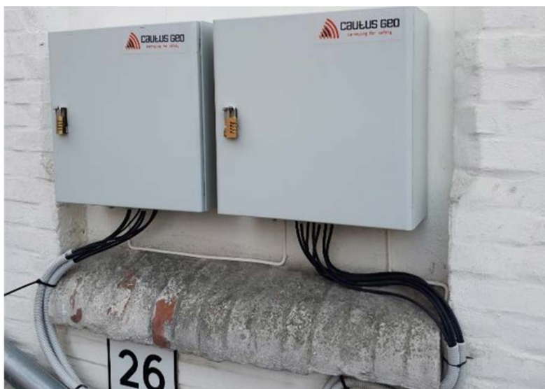
Figur 5.12: Ferdig monterte skap
