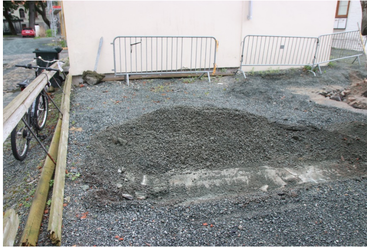
Fig. 2.13 Toppen av den støpte betongkonstruksjon i kjelleren sør for sjakt 3. Sett mot V. Da62837_001
