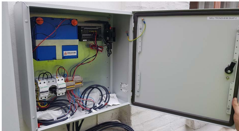
Figur 5.11: Ferdig montert skap, sett fra innsiden
