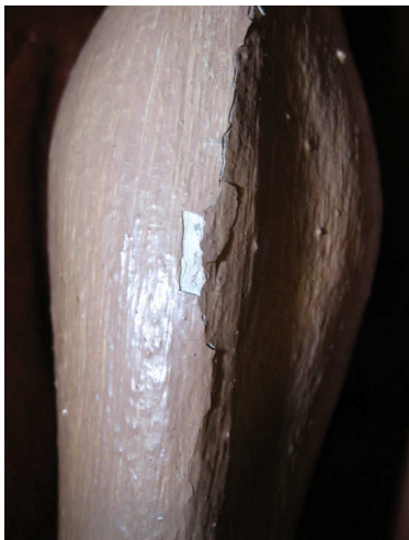
(1) Takformede oppskallinger: fra leggen til engel på venstre vinge (mot nord).
