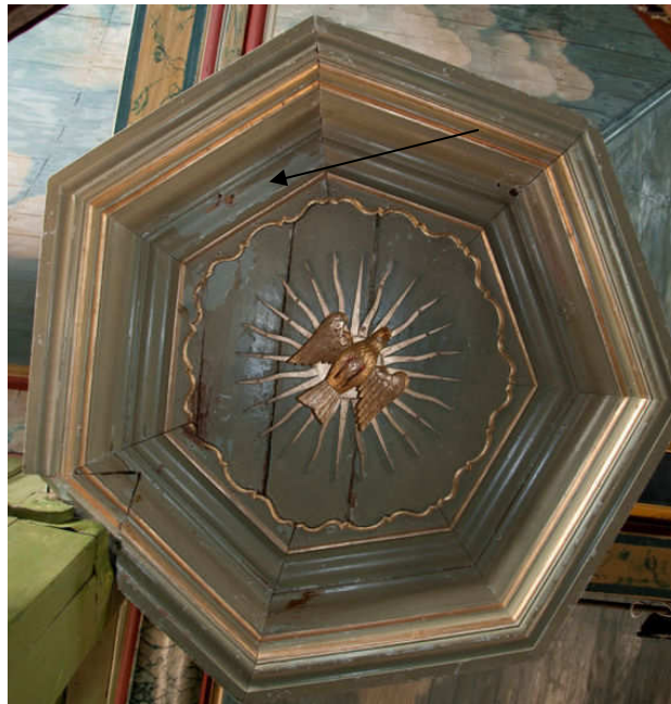
Prekestolshimlingen sett nedenfra med skader fra 1983 samt avskallinger i malingslaget.
