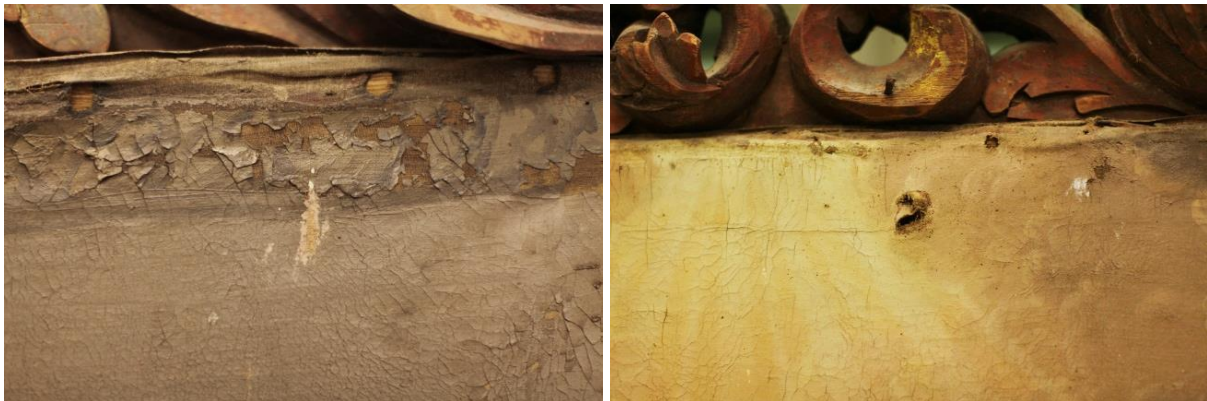
Figur 38 Detalj av maleriets øvre kant. Oppspenningen har løsnet. (foto: Karen Mengshoel, 2014)
