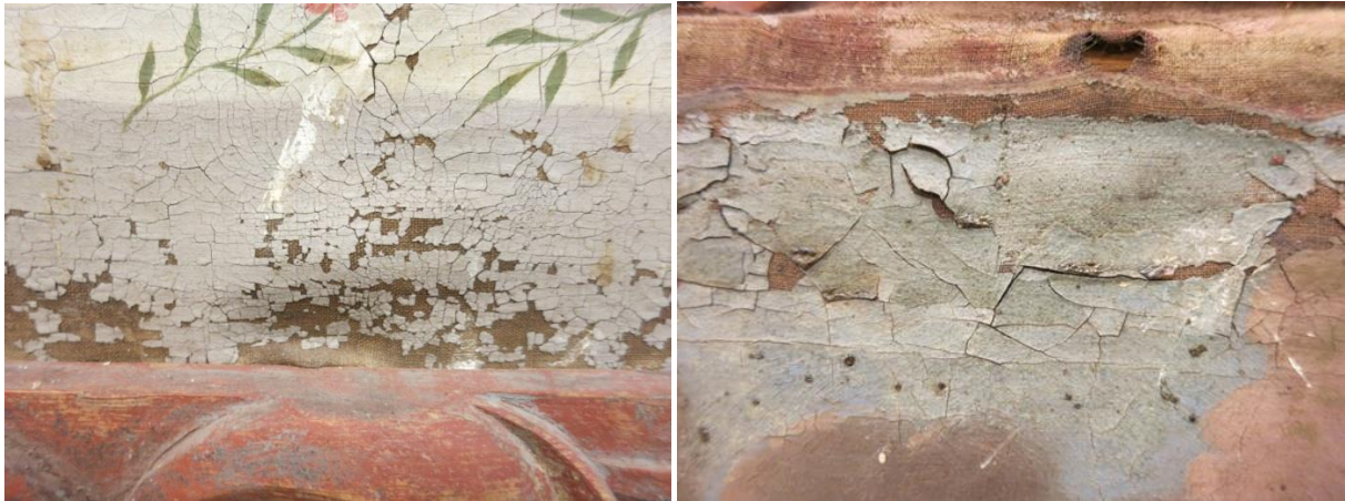
Figur 40 Løs maling, utfall, deformasjon og skålformede oppskallinger. Overflaten er skitten og har fugleskitt og malingsløp (foto: Karen Mengshoel, 2014)
