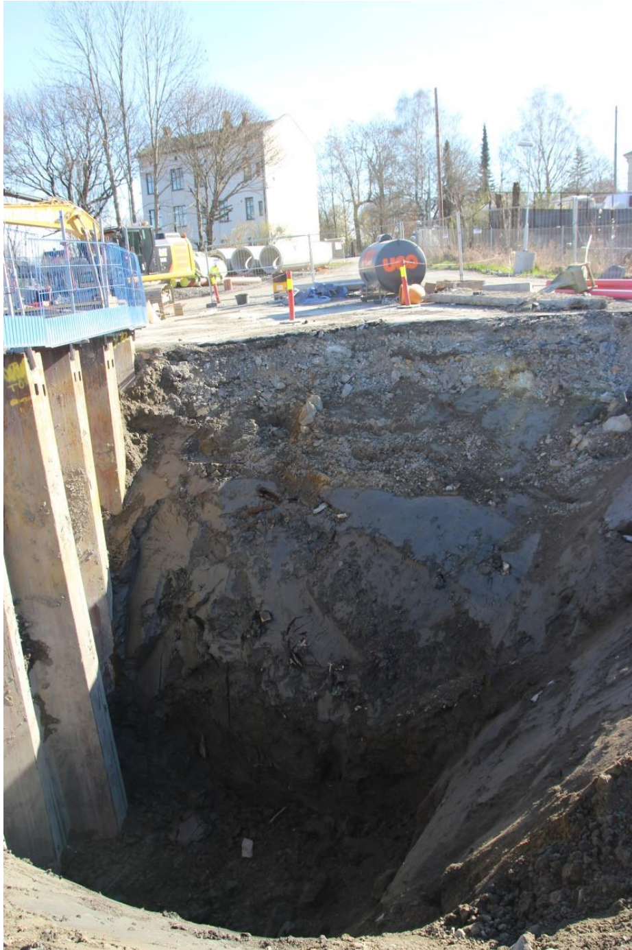
Figur 14: Grøft til pressegrøp grav til riktig nivå, etter at pressegrøpa har blitt spuntet. Sett mot øst. Foto: Cf35143_NIKU_0011.
