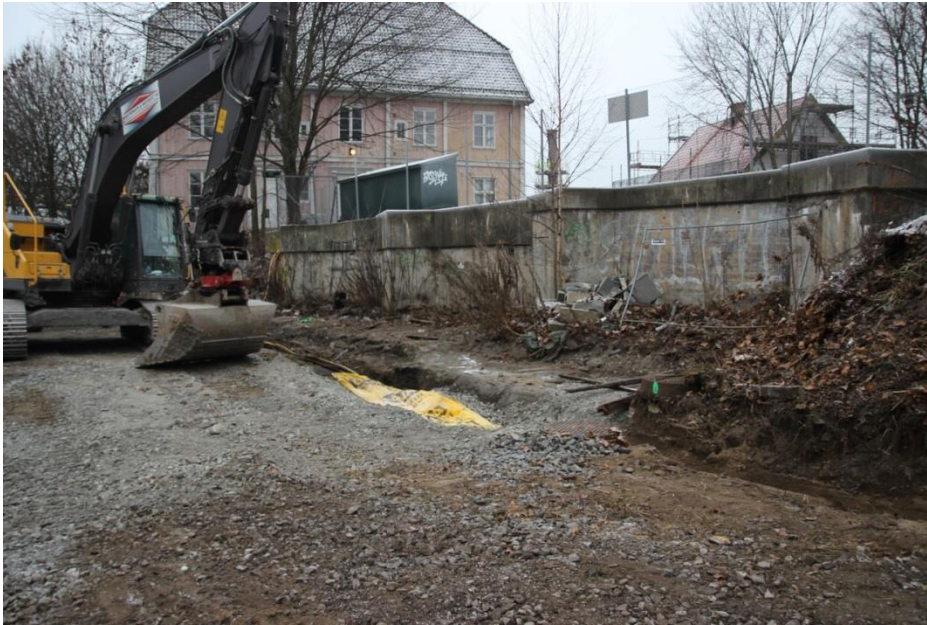
Figur 4: Mottaksgrop etter graving og igjenfylling uten arkeologisk overvåking. Sett mot vest. Foto: Cf35143_NIKU_0015.
