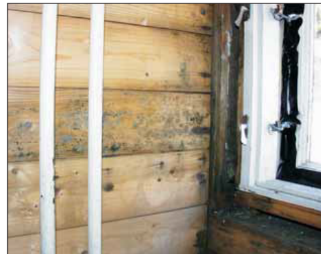
Muggvekst som en følge av kondensering av varm, fuktig luft på kalde flater.
