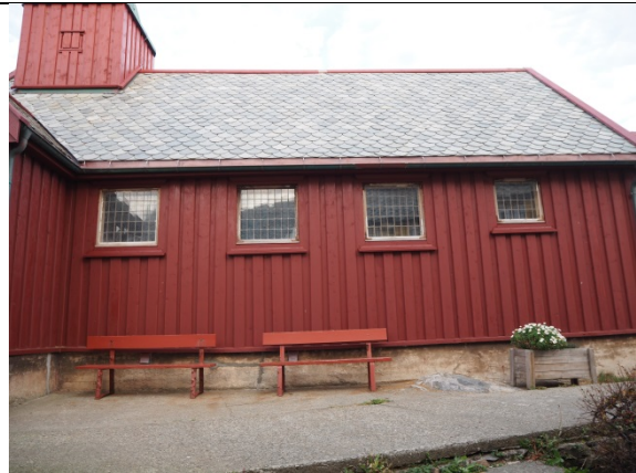
Skip og sørfasade. Kirka er kledd med ny stående panel 2015-2016 som kopi av panelet fra restaureringen på 1930-tallet.
