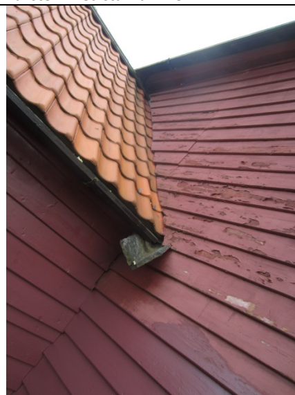
Nordvegg, sakristi til venstre. Nedre del av panelet er nymalt. En liten takrenne før ut vann vekk fra fasaden.
