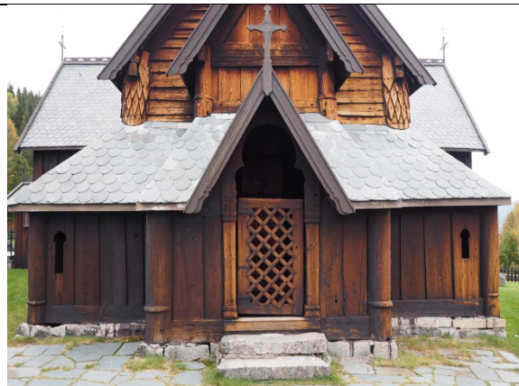
Vestportal. Grunnmuren er restaurert til høyre i bilde, men ikke til venstre.
