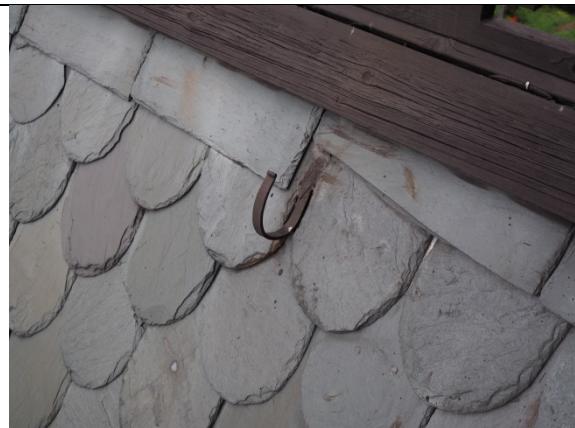
Møne, vindskie samt mønestein som er knekt. En utbedring med silikon er blitt gjort for å sikre metallkroken.
