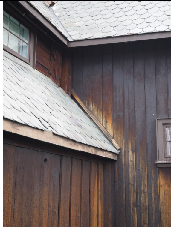
Detalj bilde av samme motiv som bildet til venstre. Skiferen er skadet og må skiftes ut. Tjæren på veggen til høyre har blitt slitt på grunn av at vann som treffer taket spruter opp på veggen .
