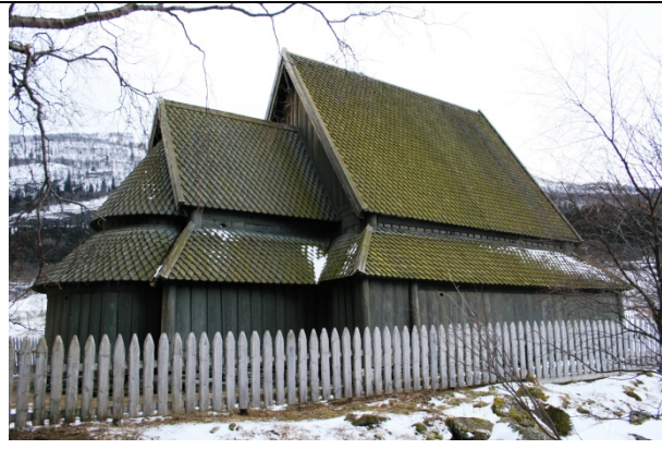
Kirkens nordvegg. Algevekst er et synlig problem.
