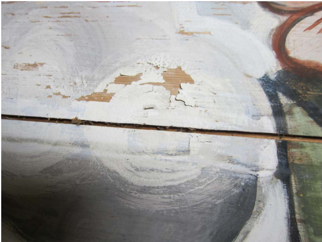
Foto 19: Detalj av en overmalt sky nær kongemonogrammet som har ulik tilstand på hvert trebord tross samme strøk med overmaling. I dette eksemplet er det derfor grunn til å tro at underlaget for malingen er årsaken til løs maling.
