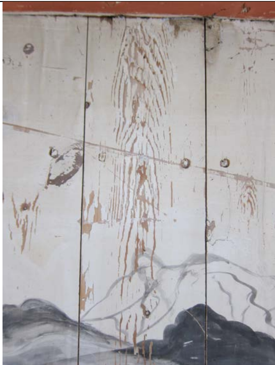
Foto 7: Detalj av korskillet vestvegg, før konservering. Her er det tydelig at skadene i limfargen følger treverkets struktur.
