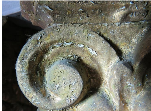
Figur 11 Detalj av en av søylenes kapitel. Oppskallinger og skitten overflate
