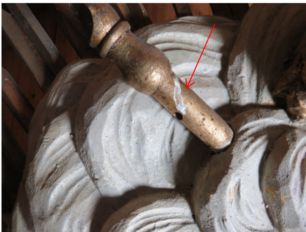
Figur 16 Fugleskitt ble renset bort
