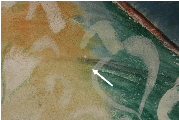
Figur 28: Vannskjold i tilknytning til en mekanisk skade.
