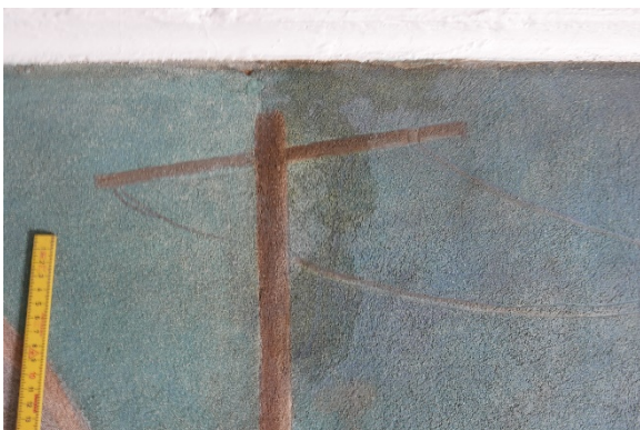
Figur 17: Vannskjolder med misfarging av overflaten, som kan skyldes en tidligere vannlekkasje.
