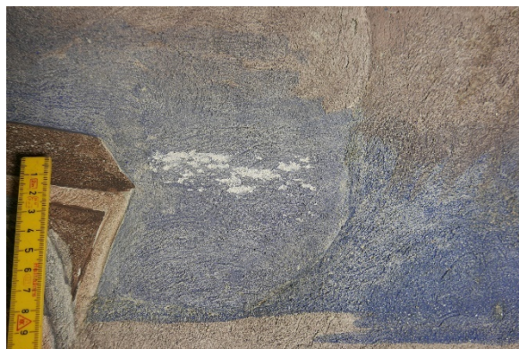
Figur 10: Mekanisk skade i overflaten.
