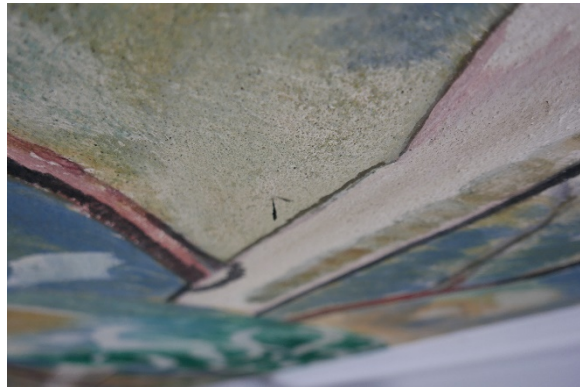
Figur 29: Maleriets overflate er noe skitten, og enkelte steder har det festet seg støvklumper.
