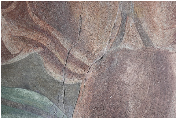
Figur 7: Vertikale sprekker i pussen. Sprekkene er kittet og retusjert.
