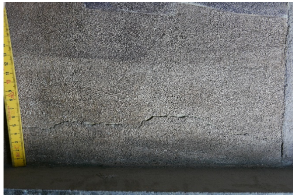
Figur 8: Nedenfor sprekken er pussen løs.
