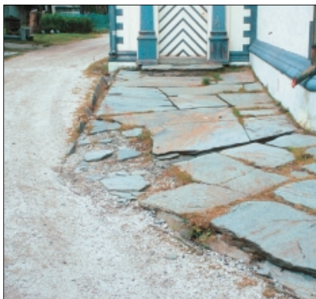
Figur 7. Detalj av helleleggingen på sydøstsiden av kirka. De fleste skadene på helleleggingen i dette området skyldes kjøretøyer, enten ved normal trafikk eller ved snøbrøyting om vinteren. Foto. J. Brønne, 2001.
