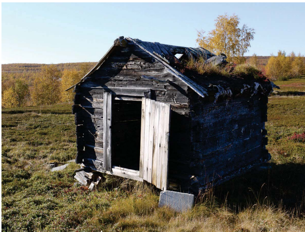
20110004009: I 2010 var tilstanden forverret og bygningen er nå sterkt truet. I Kautokeino er dette den eneste av de gjenstående bygningene i undersøkelsen som har inngått i en sosial miljøsammenheng der fiske var hovednæringsvei.
