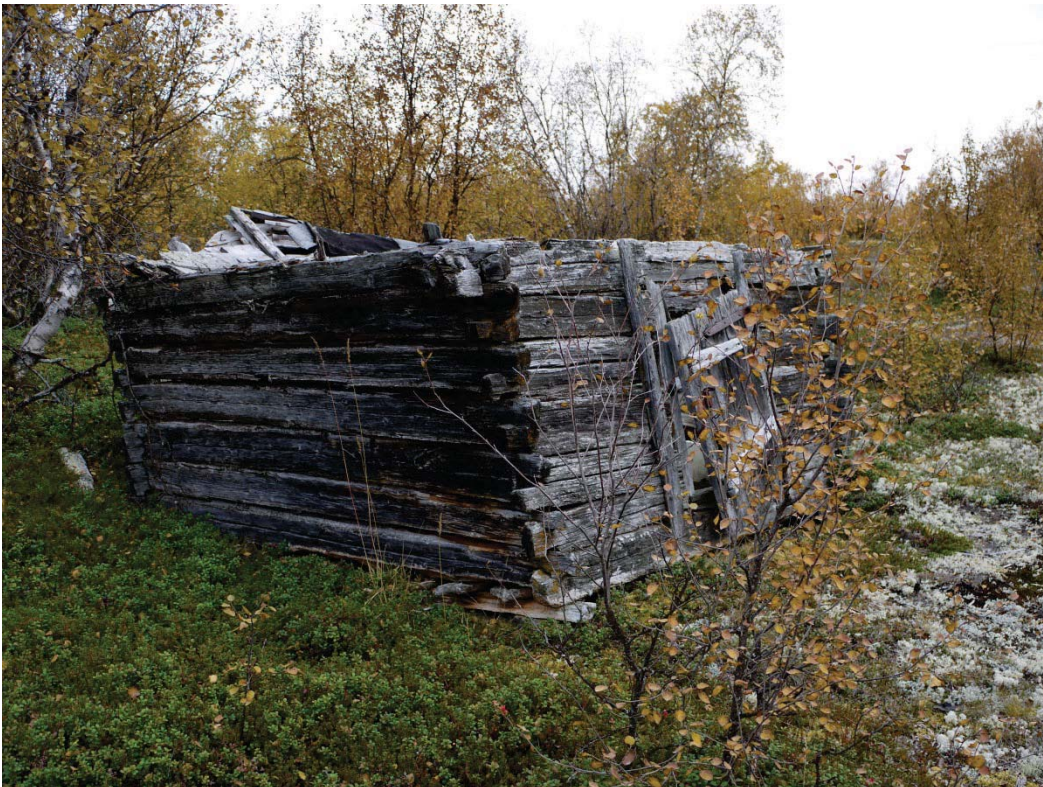
20110004026: I 2010 var forfallet kommet lenger, og bygningen er nå registrert som sterkt truet.
