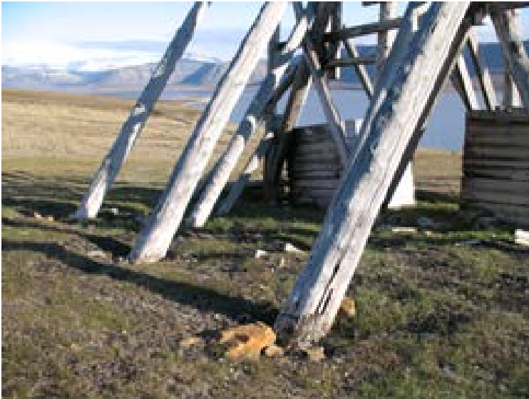
Foto 25 Bukkene har mye treverk som står i jordkontakt. Samtlige av disse materialene kan være svekket av råtesopp og må av den grunn undersøkes grundig. Foto: J. Mattsson, Mycoteam
