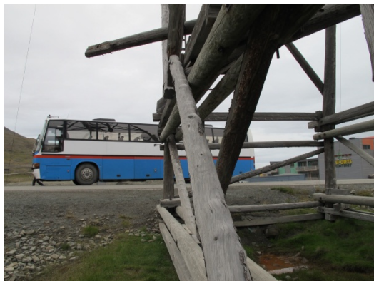
Foto 16 Konsekvensene for en kollaps av en bukk som står ved en trafikkert vei kan være store. Foto: J. Mattsson, Mycoteam
