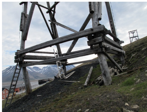
Foto 9 Fundamentet er forskjøvet slik at hele bukken står skjevt og stabiliteten er svekket. Foto: J. Mattsson, Mycoteam
