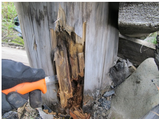
Foto 10 Omfattende indre råtesoppkader i bein til taubanebukk. Foto: AC Flyen, NIKU
