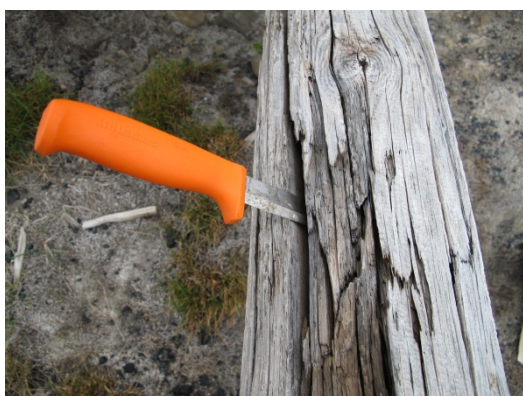
Foto 12 Råtesoppkader i rammer og avstivere til taubanebukker kan bidra til svekkelse av stabiliteten. Foto: J. Mattsson, Mycoteam
