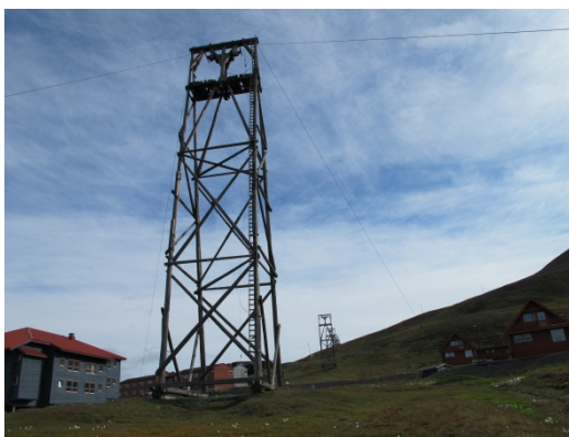
Foto 19 Det er viktig at man har god kontroll på taubanebukker inne i Longyearbyen. Foto: J. Mattsson, Mycoteam
