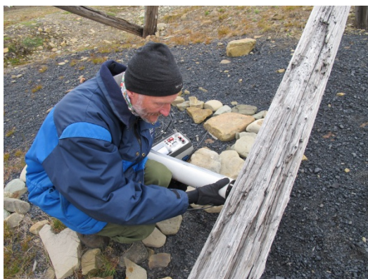
Foto 14 Råtesopp-skadene kan stort sett først klarlegges ved en inngående teknisk undersøkelse. Foto: AC Flyen, NIKU
