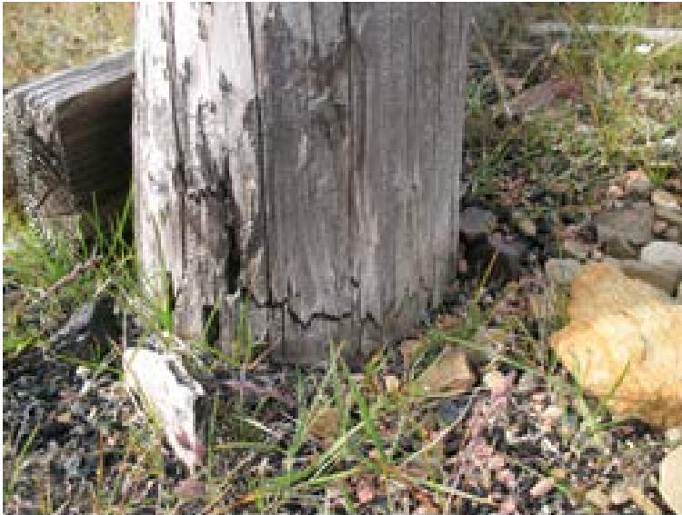
Foto 27 Ofte var det enkelte, svake tegn til en overflatisk nedbrytning av stikkene der de står i jordkontakt. Disse skadene var stort sett begrensede og forårsaket av gråråtesopper. Foto: J. Mattsson, Mycoteam
