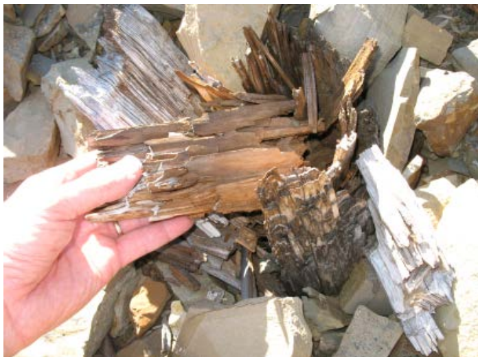
Foto 31 I den knekte stolpen ble det ved laboratorieanalyse påvist forekomst av husnettsopp. Våre undersøkelser har vist at denne råtesopparten er vanlig å finne i nedbrutt treverk på Svalbard. Den forårsaker omfattende skade i treverk med jordkontakt. Foto: J. Mattsson, Mycoteam
