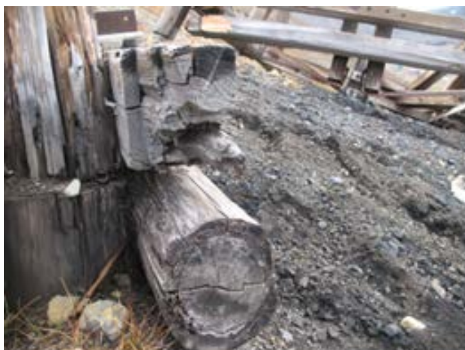
Foto 6 I forbindelse med en synlig snittflate på liggende tømmer er det mulig å registrere tegn til omfattende råtesoppskade i indre deler. Hvis stokken hadde stått nede i bakken, ville skaden vært usynlig. Foto: J. Mattsson, Mycoteam
