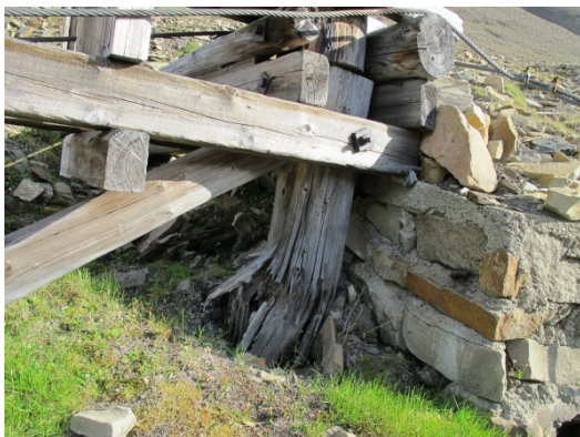
Foto 8 En knusningsskade i et fundamentben viser at det er en kritisk svekkelse av stabiliteten til bukken. Foto: J. Mattsson, Mycoteam
