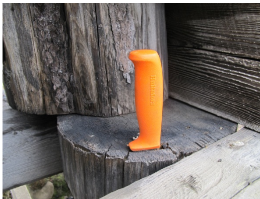
Foto 11 Enkelte fundamentstolper er sterkt råtesoppskadet i øvre del. Foto: J. Mattsson, Mycoteam
