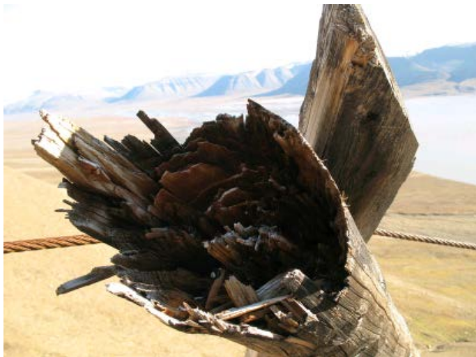
Foto 29 Råteskadene på bukkens fundamentben har startet fra innsiden og er vanskelige å oppdage fra utsiden. På denne stokken er kun et tynt «skall» igjen utenpå den sterkt svekkede stokken. Bruddflaten er ved overgangen mellom bakke og luft. Foto: AC Flyen, NIKU
