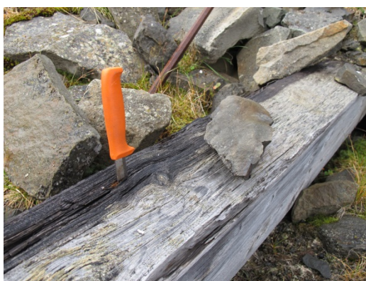
Foto 13 Enkelte av skadene er vanskelige å oppdage uten inngående undersøkelse. Foto: J. Mattsson, Mycoteam
