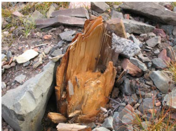
Foto 5 Meget kraftig råteskade i indre deler av tømmer har ført til en ødeleggelse av taubanebukken. Skaden var ikke mulig å se fra overflaten. Det er slike skader vi var på jakt etter i bukkene på Hiorthhamn og i Longyearbyen. Foto: J. Mattsson, Mycoteam
